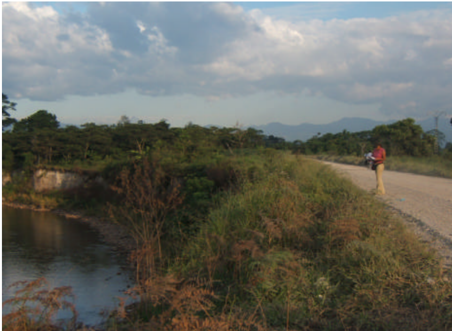
Foto 6.19 Erosión fluvial por la margen izquierda del río Occhique, puede afectar a la carretera Soritor-San Marcos.
