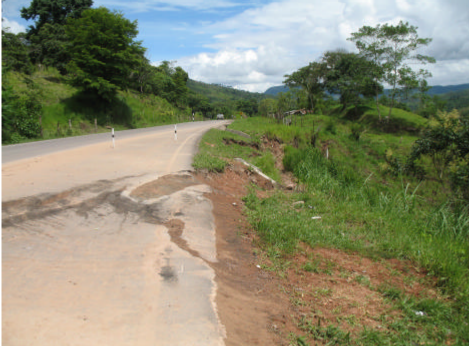
Foto 6.3 Deslizamiento en la carretera Moyobamba-Tarapoto, km 517, (distrito Tabalosos, provincia Lamas).
