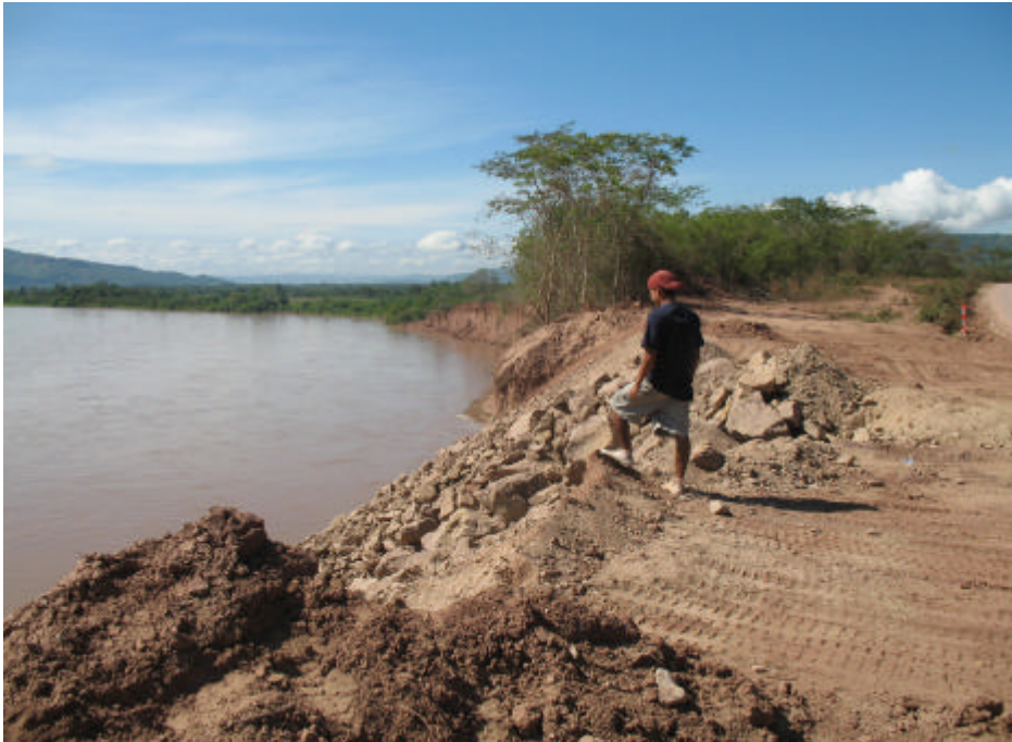
Foto 6.17 Sector de Pucacaca, margen izquierda del río Huallaga. Carretera Tarapoto-Picota Km. 45+300, nótese que el río está erosionando este sector, muy cerca se encuentra el trazo de la carretera.
