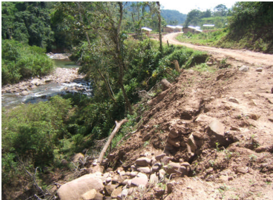
Foto 6.18 Sector Caserío La Unión, se aprecia la erosión fluvial del río Occhique sobre su margen derecha, puede afectar a la carretera de acceso.
