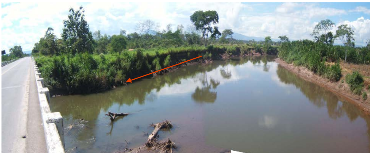
Foto 6.12 Puente Tonchima, se aprecia erosiones fluviales sobre la margen derecha. (junio del 2007).
