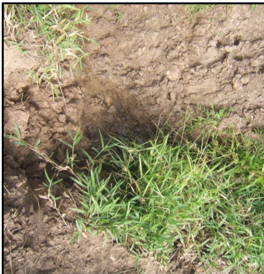
Foto 7.- Afloramiento de agua, ubicado en la parte central del deslizamiento
