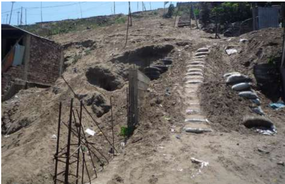
Foto 15. AH 08 de Enero. Arenas cubren el acceso peatonal que está hecho de costalillos de arena. Se observa muro de vivienda casi enterrado.
