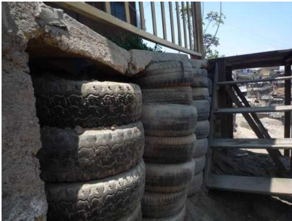
Foto 11. AH 08 de Enero - Sector A. Obsérvese los muros de llantas sobre los q se construyen las viviendas de material precario.
