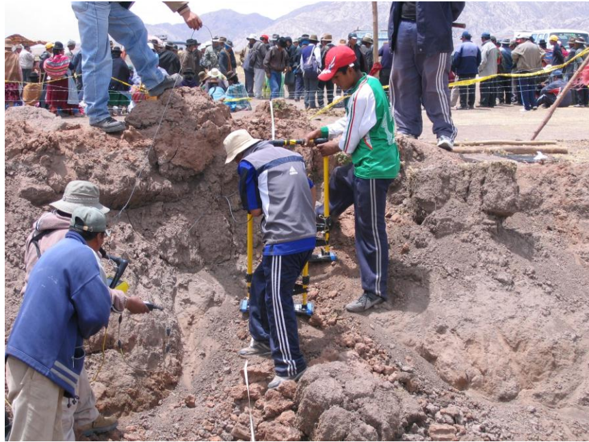
Foto N° 3: Suelo de la Explanada, se puede ver una primera capa poco consolidada, seguida de una capa de gravas finas, gruesas y bloques, con una matriz arcillosa.
