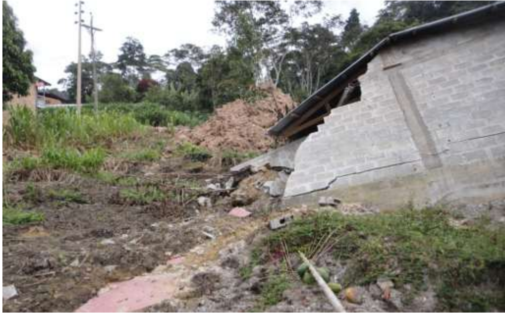
Foto 26. Iglesia y viviendas colapsadas por el arrastre diferencial entre la superficie del fondo del flujo y la parte superficial el del flujo de tierra en Pacaypite.
