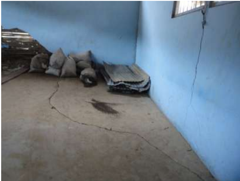
Foto 19. Agrietamientos de un aula del centro educativo Carrizal.
