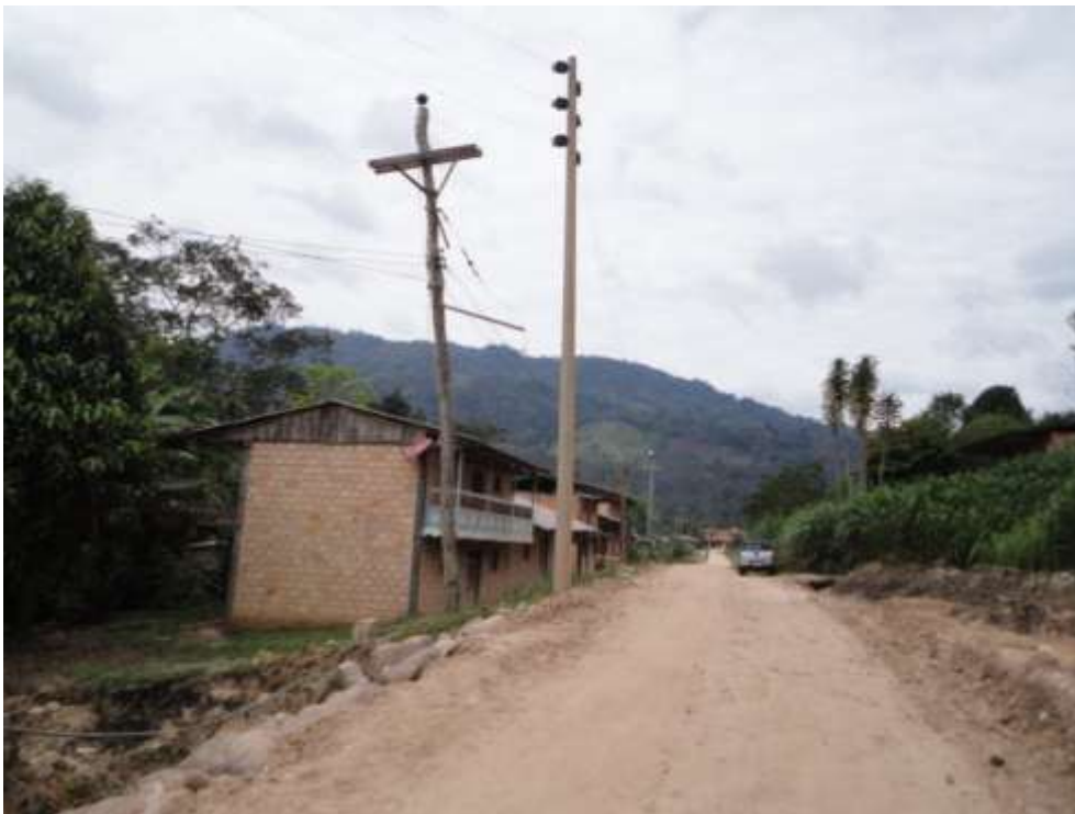
Foto 29. Poste de tendido eléctrico inclinado, por efecto del movimiento.
