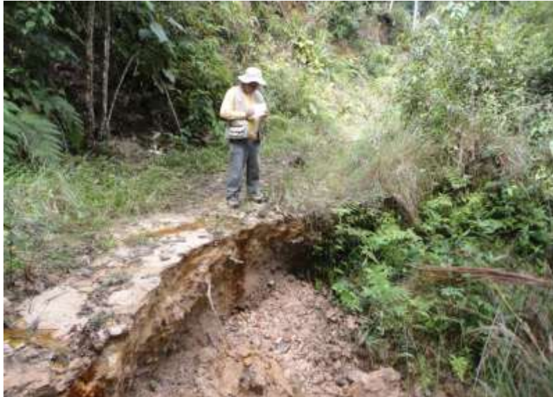
Foto 10. Cabeza de la erosión en cárcava que afecta a un tramo de la antigua carretera de Jepelacio hacia una torre de alta tensión.
