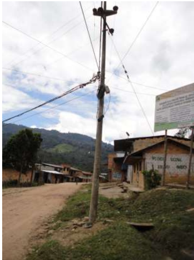
Foto 31. Poste de tendido eléctrico con una ligera inclinación.
