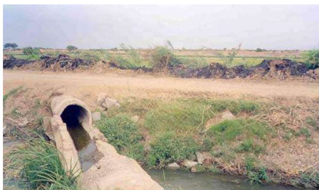
Desalojo de aguas servidas al curso del Dren 3000, debido a la ausencia de sistemas para la disposición final.
