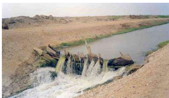
Vista del Dren 3000, notese el represamiento del agua para el riego por rebose.
