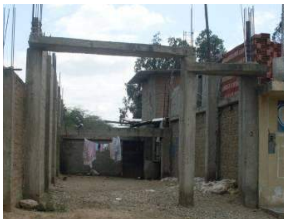
Figura 10.25.- Separación de columnas en edificio de concreto armado
