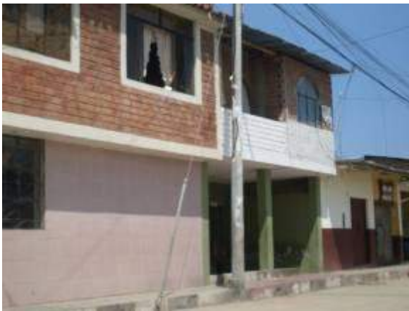
Figura 10.10.- Edificio de concreto armado, separación de elementos de concreto de los tabiques. (Calle Tarata)
