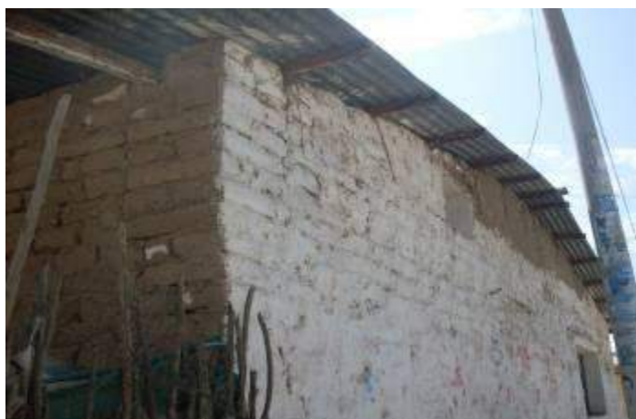
Figura 10.14.- Deficiencias en el proceso constructivo de muro, conllevan a una mala calidad de la mampostería de adobe en conjunto.
