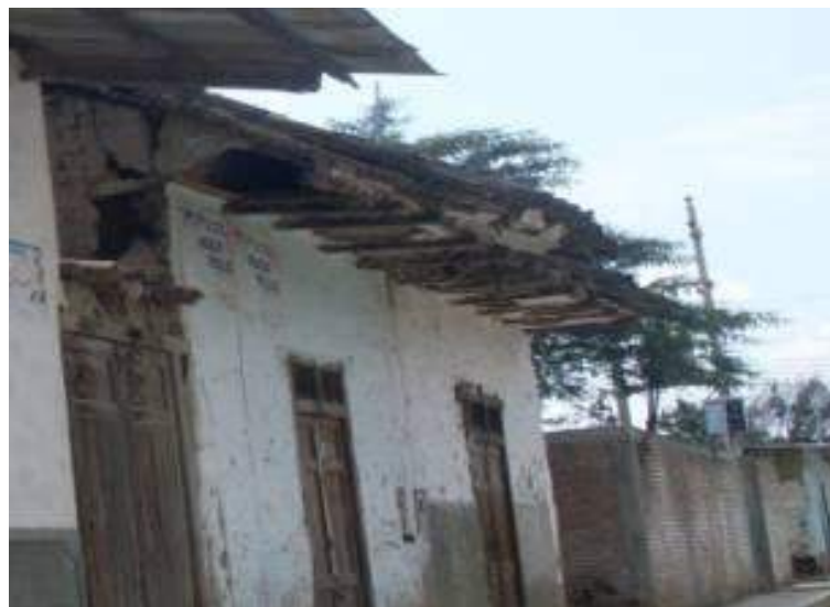
Figura 10.19.- Techo compuesto de caña y viga de madera en mal estado.
