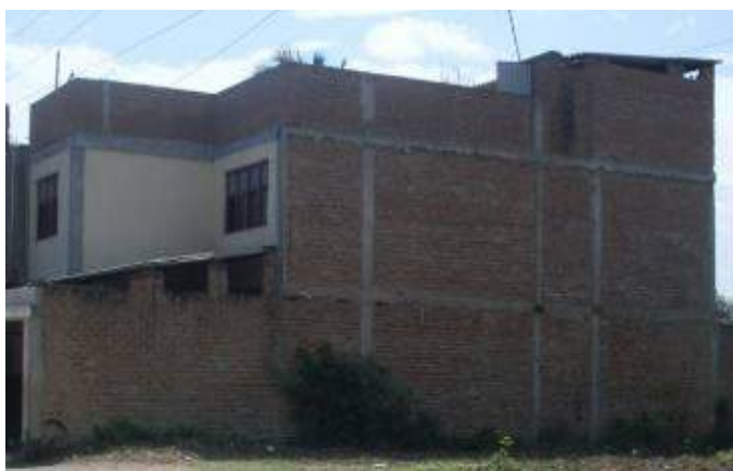
Figura 10.25.- Separación de muros más distanciados con respecto a otros.
