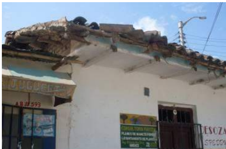
Figura 10.28.- Cubierta de caña en mal estado y tejas sueltas.
