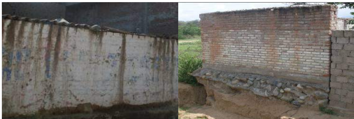
Figura 10.17.- Izquierda: Parte inferior de muro, debilitado por acción de humedad y sales, fallará posiblemente por flexión perpendicular al plano del muro con agrietamiento vertical. Derecha: cimentación expuesta y en peligro de colapso - Estadio.
