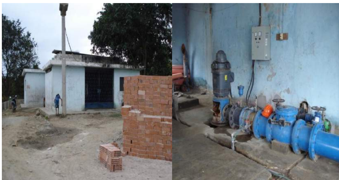
Foto N° 10.- Caseta de la Poza N° 01 y su bomba de impulsión
