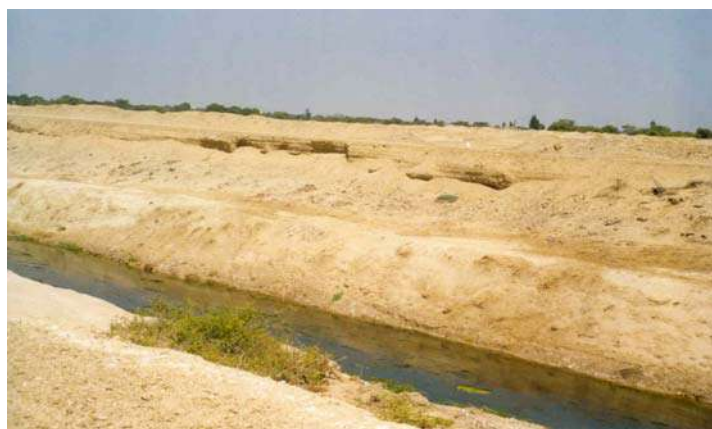
Vista de la alta concentración de sedimentos sólidos en el área de confluencia de los Drenes 1400 y 1000.
