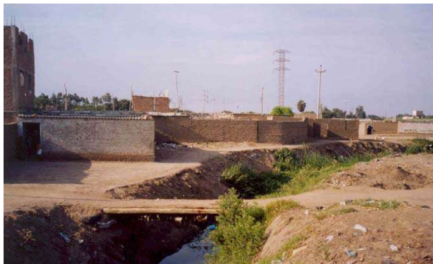
Vista de la precariedad construida del ponton peatonal ubicado al Sur - Este de la ciudad sobre el Dren 2210.
