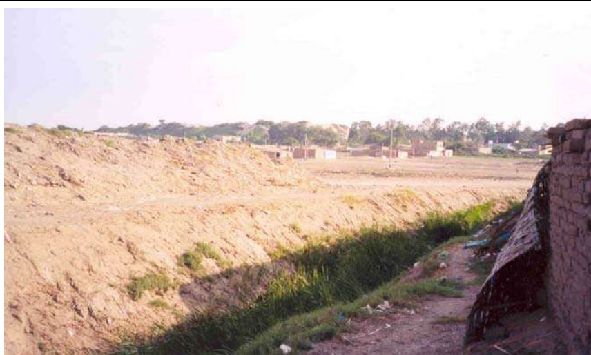
La Construcción de nuevos pontones está dirigida a mejorar la accesibilidad de las áreas periféricas.
