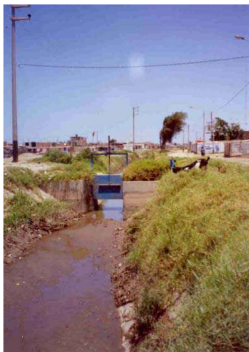
Vista de la vulnerabilidad física de la infraestructura de riego que atraviesa la ciudad.
