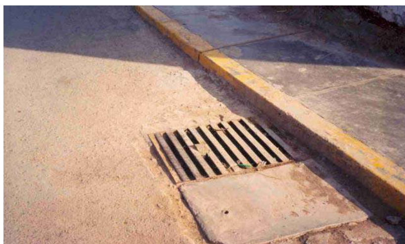
Situación actual de la infraestructura de Alcantarillado.
