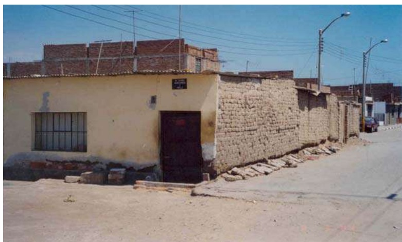
Vista exterior de una vivienda que evidencia deficiencias en el diseño y sistema constructivo. Nótese la ocupación de la sección vial, la ubicación de los postes de tendido eléctrico y el nivel del primer piso respecto al nivel de la vía.
