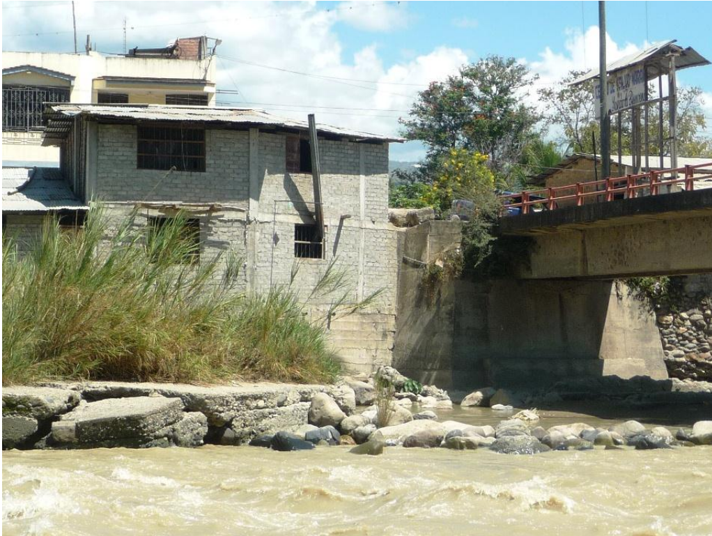
Foto N° 14. Viviendas en Puerto Naranjitos construidas a la orilla del río Utcubamba
