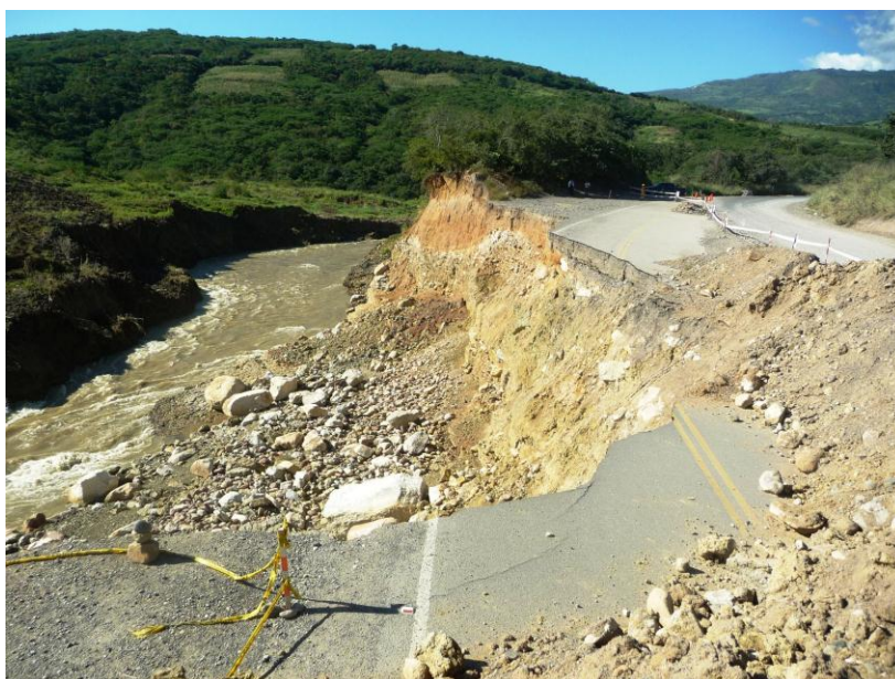
Foto N° 13. Plataforma de Carretera Belaunde Terry afectada por erosión fluvial durante la ocurrencia del Flujo de Tierra.
