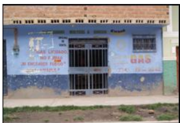
Av. 28 de Abril N° 541, distribuidora de gas ESMA – San Cristóbal.
