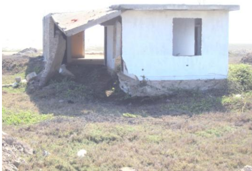
Foto Nº. 05 .- Vista Panorámica de Huanchaquito Bajo donde se aprecia una casa derrumbada por socavación como salida del agua del mar.
