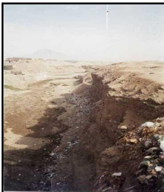
Foto N° 35 Muestra de la erosión provocada por las aguas de la quebrada Río Seco
