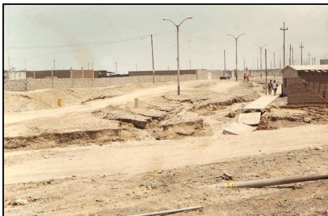
Foto N° 47 Daños en infraestructura
