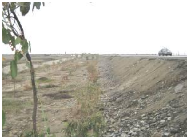
Vista de la dirección que toma el flujo hacia Huanchaquito, debido a que el relleno de la vía de Evitamiento actúa como un dique deflector.
