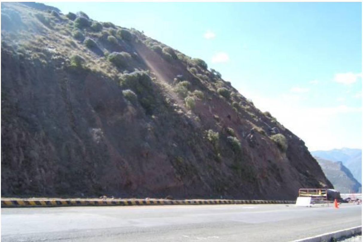
Foto 64 Km 15 al 18 (Concococho-Antamina), cerca de Aquia, zona crítica por derrumbes y caída de rocas.
