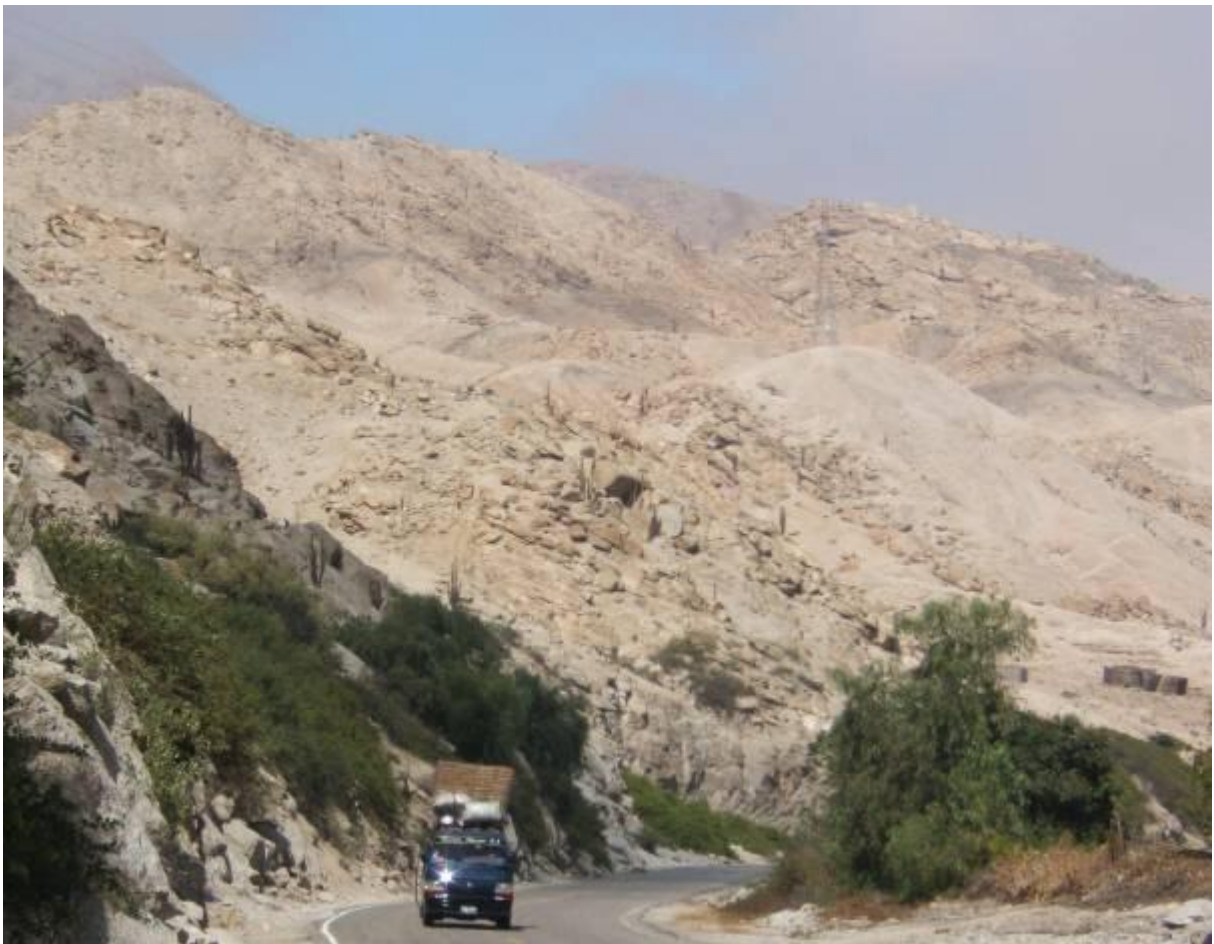
Foto 63 Laderas y taludes en el cerro Berraco, zona crítica por caída de rocas y derrumbes.
