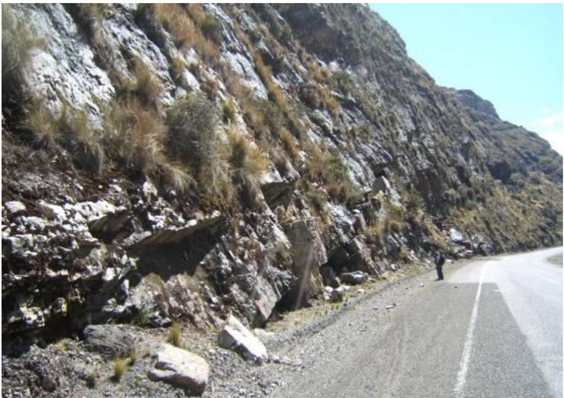
Foto 37 Taludes de corte afectados por vuelco de estratos en el tramo 43+100 al 43+240 Conococha-Antamina.
