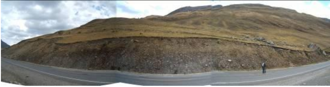
Foto 55 Corte de carretera sobre depósito antiguo de deslizamiento-flujo, sector cerro Shushy, Km 70+500 al 70+915 Conococha-Antamina; derrumbes en los cortes recientes.
