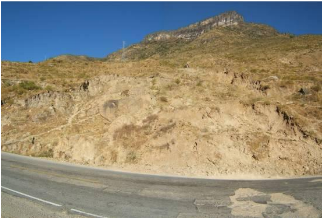
Foto 50 Pequeño deslizamiento en el sector de la ladera media de la quebrada Palpín (Km 95 Pativilca-Conococha).
