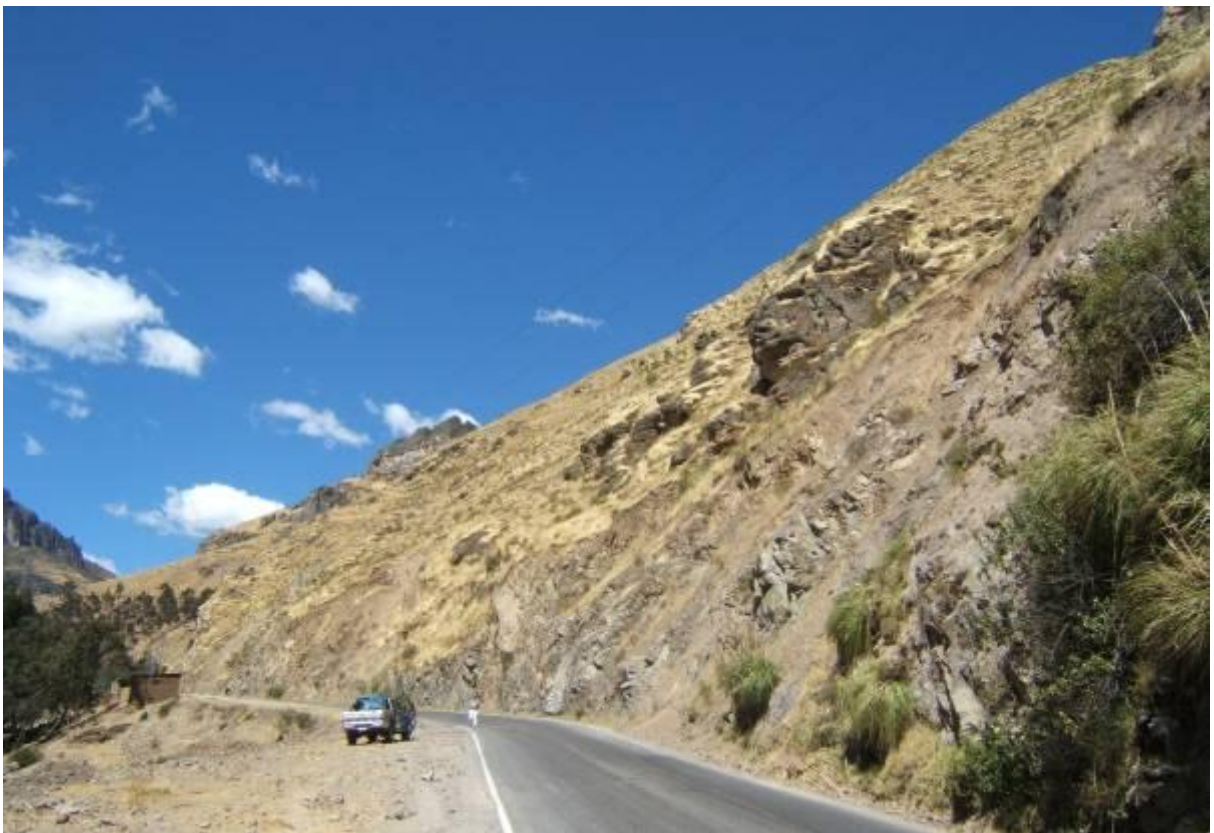
Foto 61 Sector de Mayorarca y cerca de puente Mellizos, zona crítica por derrumbes.
