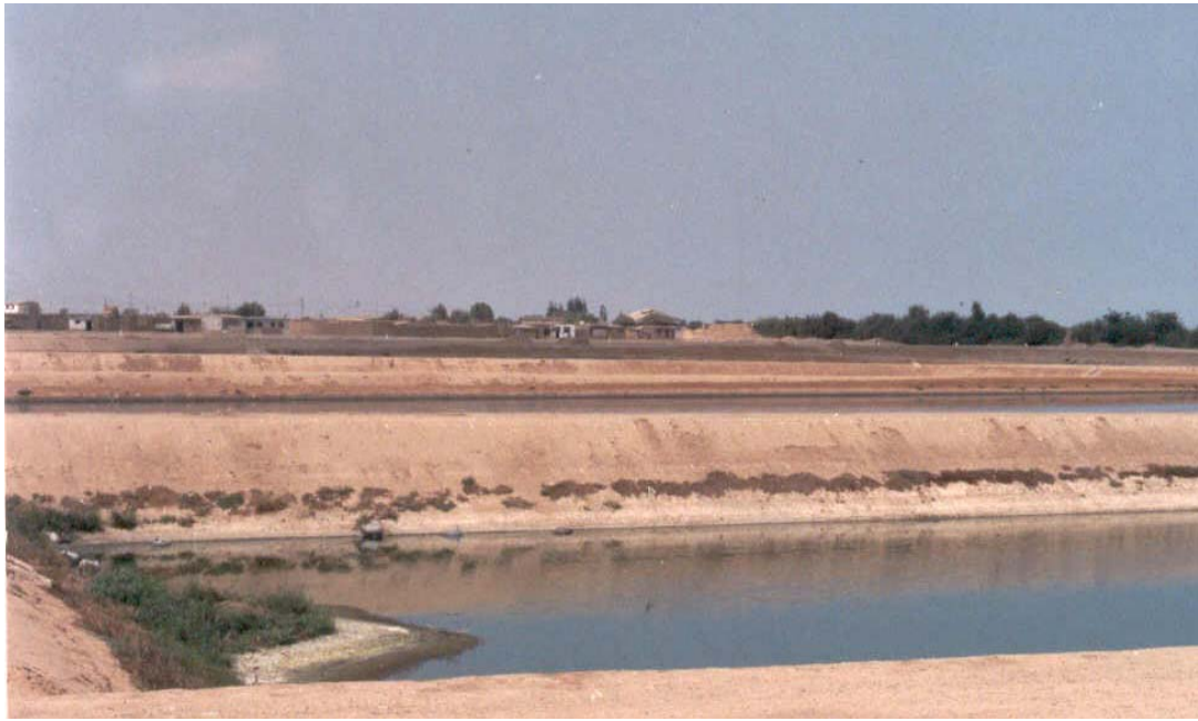
Figura 4.19. Lagunas de sedimentación del sector Valdivia Alta del distrito La Esperanza con taludes deteriorados; a escasos metros de éstas se encuentran viviendas y cultivos.
