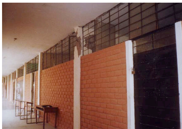
I,E Gabriel Ramos, presenta daños severos (problema de "columna corta")
