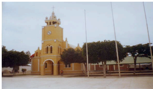
La iglesia con daños severos en la torre presencia de fisuras (daño moderado)
