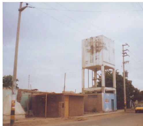
Reservorio con daños moderados (entre la cubeta y encuentro de columnas y vigas)
