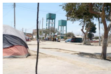
El reservorio antiguo (daño moderado) y el nuevo (daños leves)
