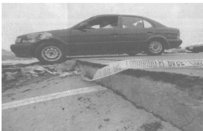
Daños en la carretera Panamericana Sur Foto: Almanaque Estadístico de Ica. INEI
