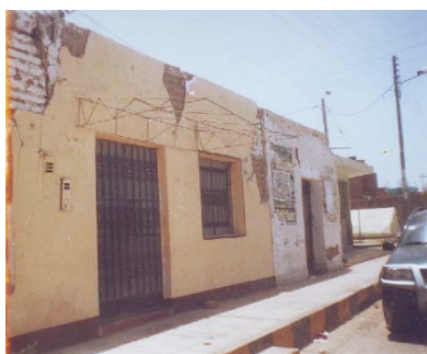
Vivienda de adobe seriamente afectada por el sismo
