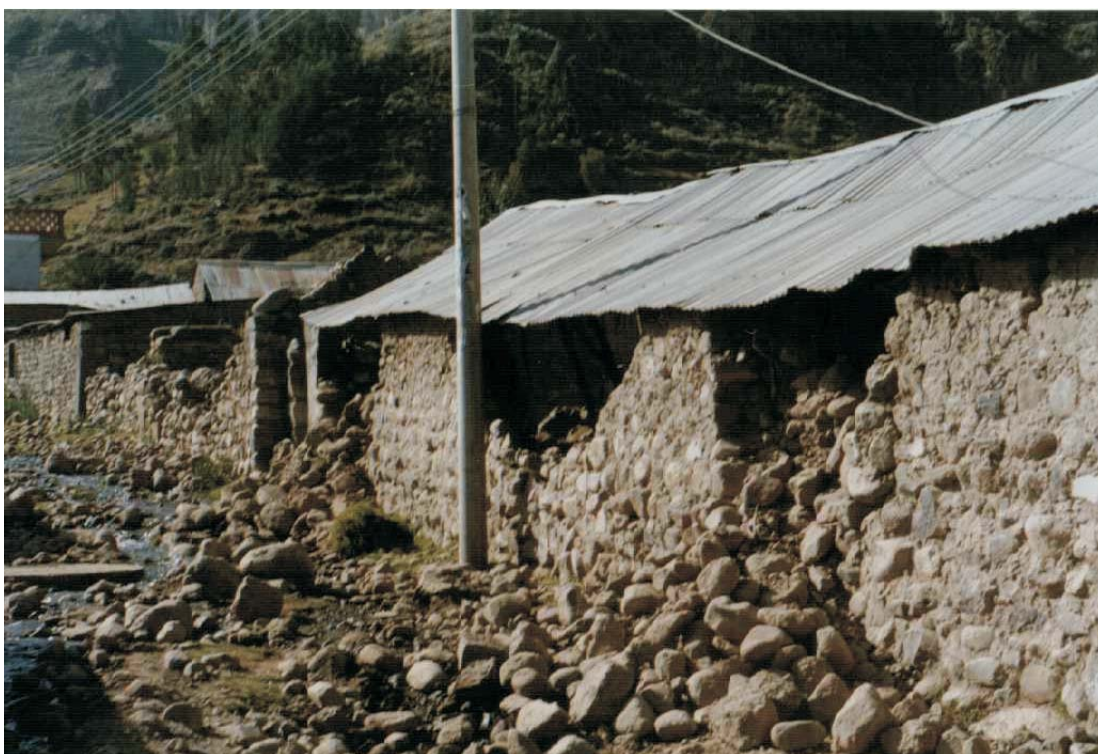
Foto 9: Derrumbes en los muros de las viviendas en la calle Sucre segunda cuadra - Huanca
