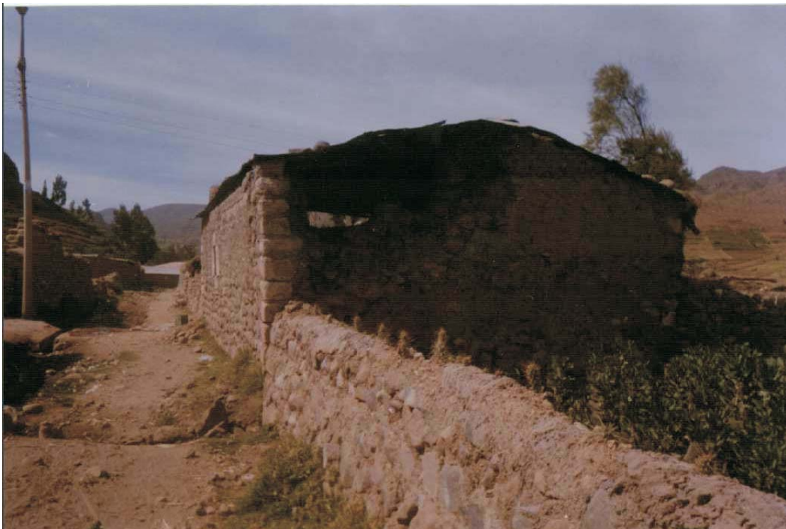
Foto 20: Vivienda afectada por el sismo del 23 de junio del 2001, calle 3 de Setiembre - Huanca
