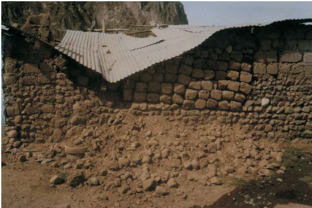
Foto 14: Caída de paredes en las viviendas de la calle Miguel Gráu - Huanca
