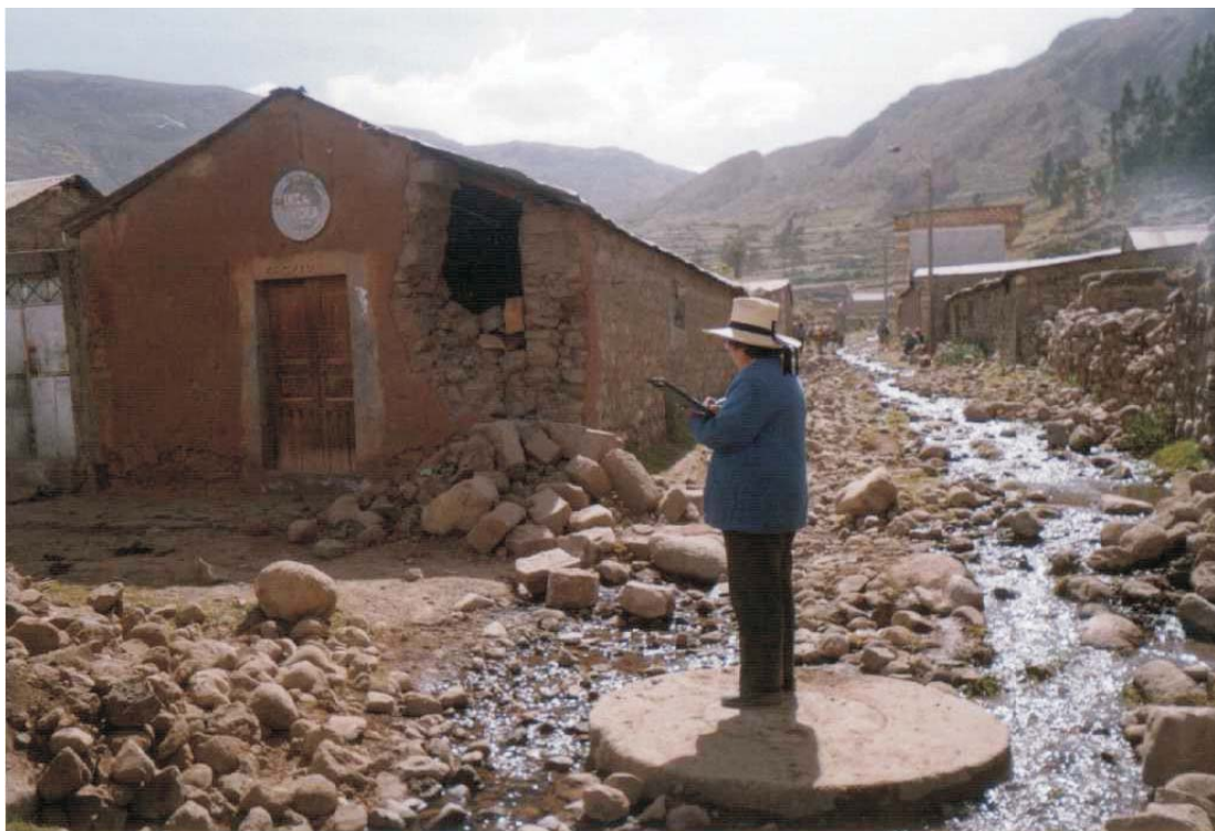
Foto 10: Caída de paredes en la calle Miguel Gráu, a consecuencia del sismo del 23 de junio del 2001
