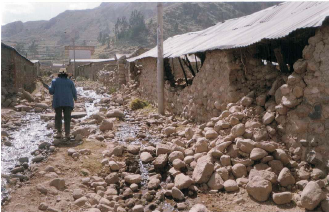
Foto 12: Caida de muros en la calle Sucre segunda cuadra - Huanca
