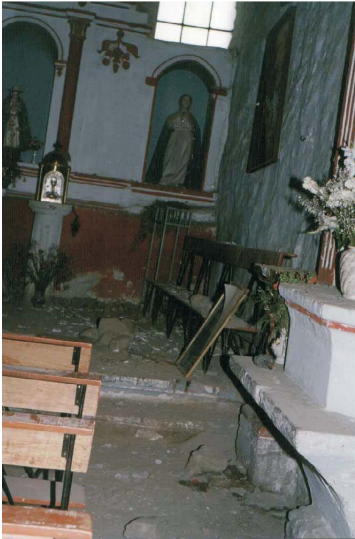
Foto 21: Daños en el interior de la iglesia de Huanca
