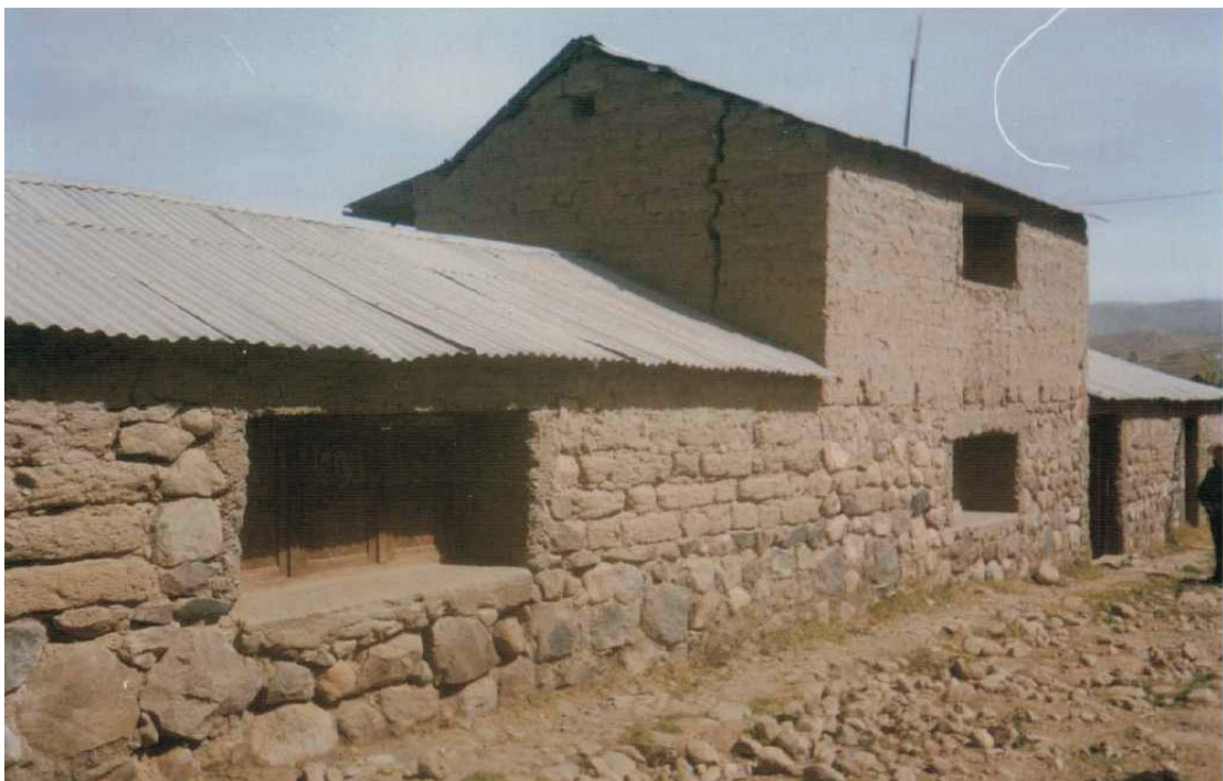
Foto 16: Agrietamientos de paredes en la calle Junín Sexta cuadra - Huanca
