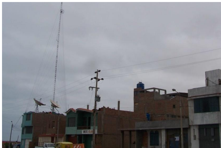
Foto N° 56. ANTENAS DE TRANSMISION DE TELEFONIA MOVIL Y RADIO
