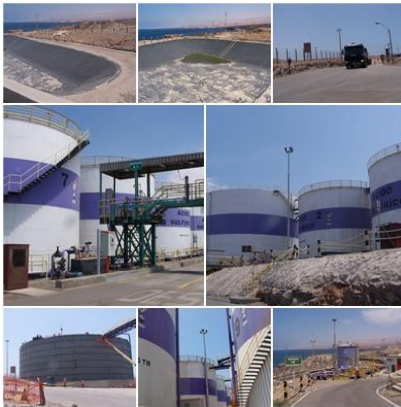
Foto N° 50. ALMACENAMIENTO DE ACIDO SULURICO
