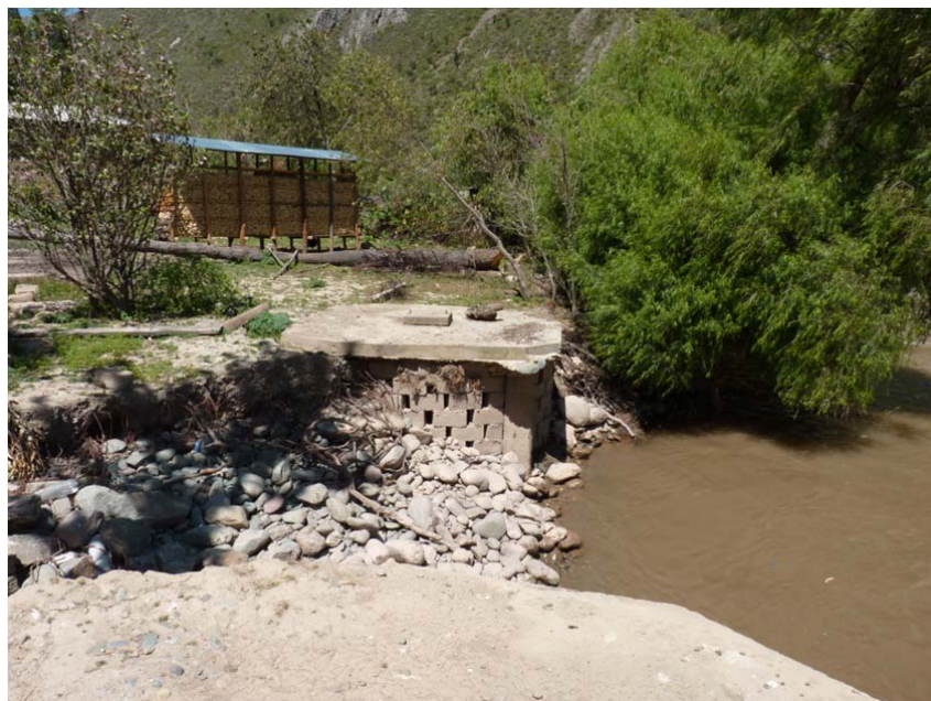
Foto 05: La crecida del río Vilcanota produjo la erosión de la zona urbana. En la foto se aprecia la exposición de un buzón de desagüe.
