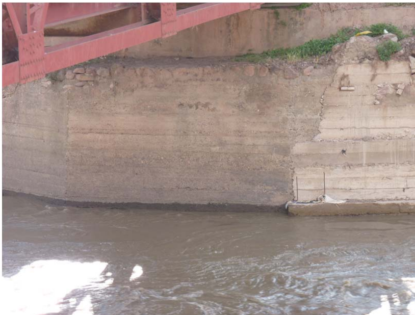
Foto 12: Vista de los cimientos del Puente Huayllabamba, los cuales, por debajo del nivel del río están erosionados.
