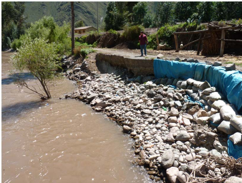
Foto 06: Erosión en el tramo de carretera Ollantaytambo – Piscaycucho que también afectó la línea férrea Ollantaytambo – Aguas Calientes.
