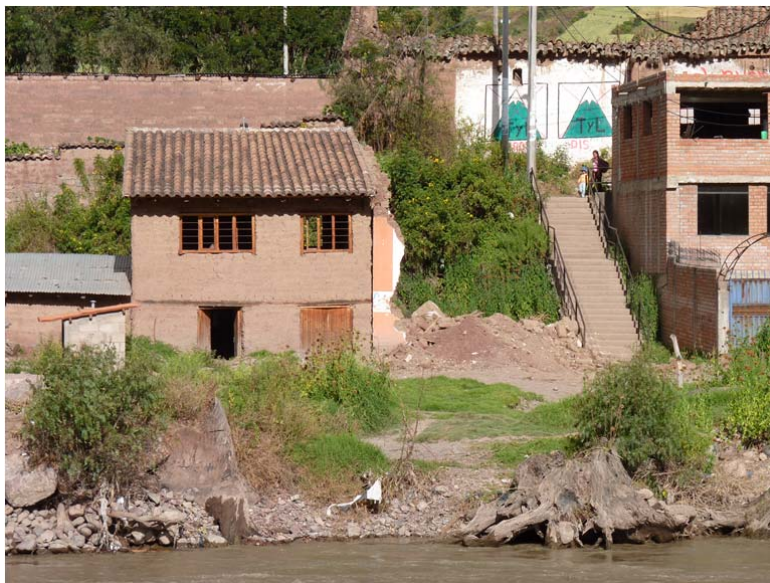
Foto 10: Vista de lo que fue una vivienda, la cual colapso producto de las crecidas del río Vilcanota.
