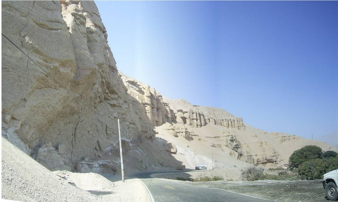
Derrumbes del Cerro Huancarqui afectan a aproximadamente 500 m. de carretera desde la salida del puente de Aplao.
