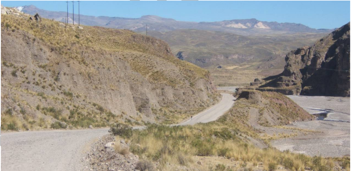
Sector de Callalli. Tramo de carretera de unos 600m que se ve afectado por derrumbes y huaycos.
