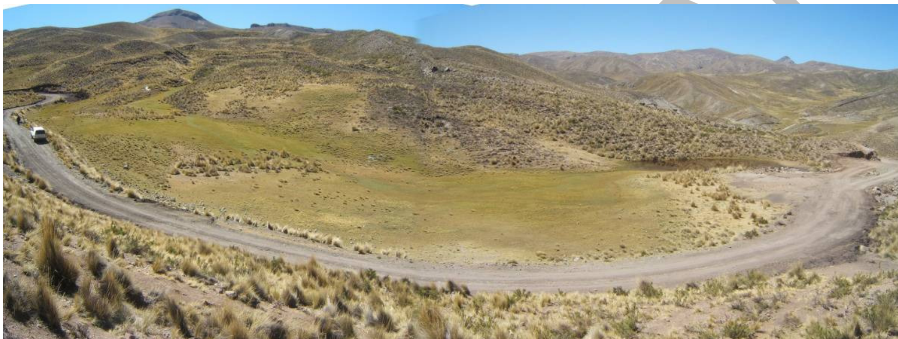
Carretera en el sector de Coccha, que accede al distrito de Tisco, se ve afectada por un deslizamiento rotacional.
