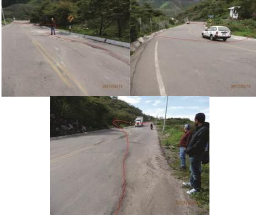
Foto 5. Vista de agrietamiento con dirección este, se observa en la capa asfáltica de la carretera el Chilete – San Pablo.
