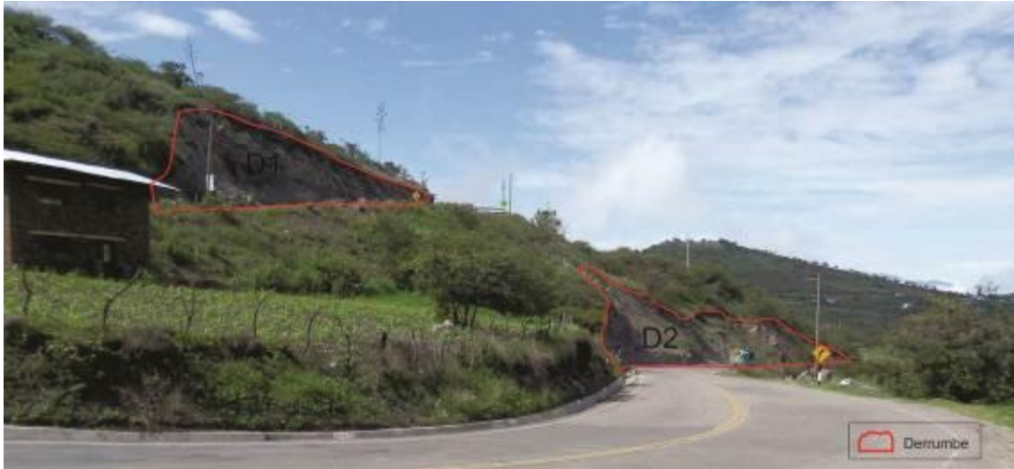
Foto 8. Se observa caída de rocas en talud superior de tramo de carretera en las progresivas 24+762 (D2) y 24+520 (D1).
