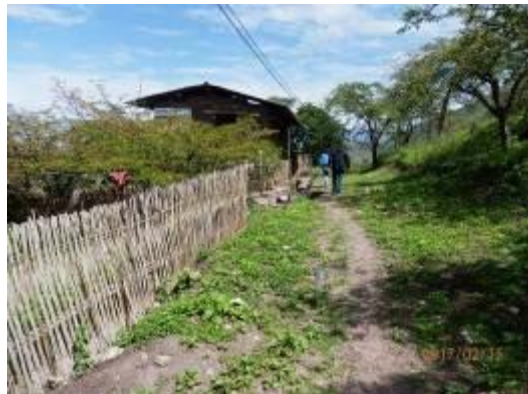
Foto 6. Vista al pie del deslizamiento donde se ubica una vivienda que podría ser afectada
