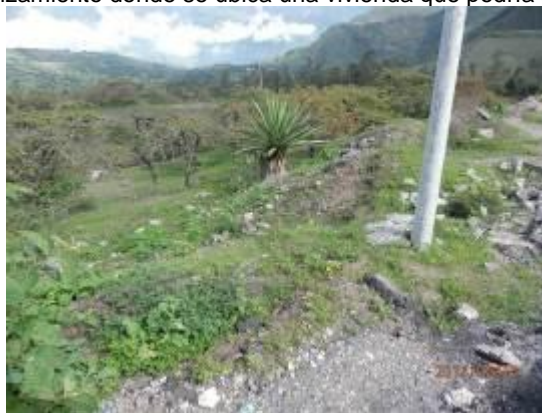
Foto 7. Vista la parte superior del deslizamiento, se observa agrietamiento que puede afectar poste eléctrico
