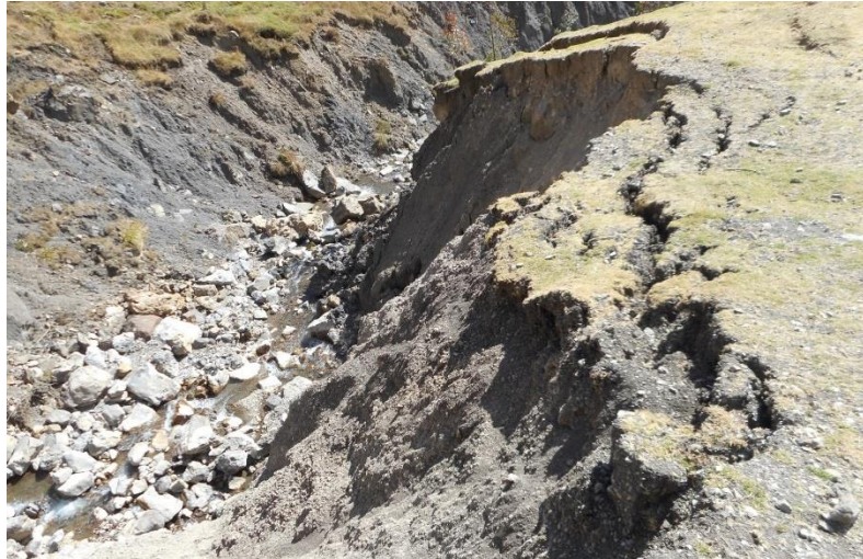
Foto 14: El caudal de la quebrada Chagavara se incrementa afectando el cauce de la misma, en el mes de enero del presente año ocasiono la pérdida de una parte de la carretera.
