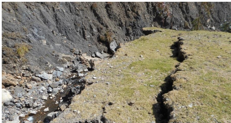
Foto 15: La formación de escarpas y agrietamientos ha afectado zonas de cultivo, accesos, puentes artesanales y caminos de herradura.
