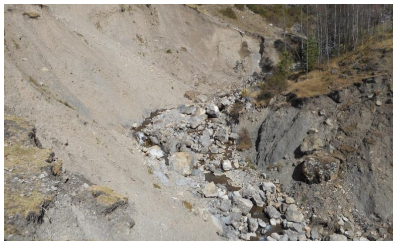
Foto 05: La quebrada Chagavara, desciende desde el cerro Ventanas con una fuerte pendiente incrementando su poder erosivo, afectando la carretera Chagavara - Sitabamba.
