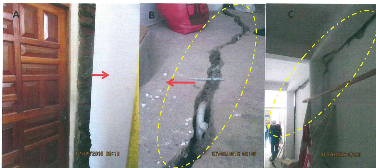
Foto 03. A. Desplazamiento horizontal (18 cm) de muros producto de activación de deslizamiento B. Agrietamientos en pisos que dejan expuestas tuberías. C. Fisuramientos y desplazamientos de muros como consecuencia de activación de deslizamiento. Las flechas rojas indican la dirección de movimiento del deslizamiento
