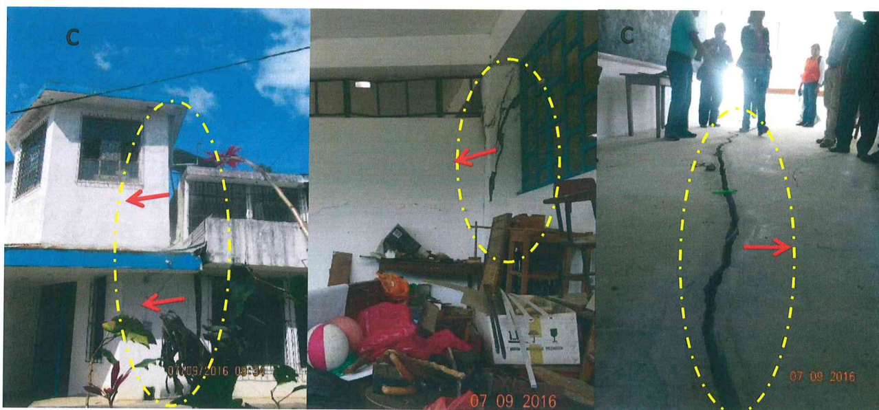
Foto 02. A. Desplazamientos horizontales que generan separación de muros. B. Fracturas en columnas C. Grietas tensionales en los pisos de las aulas del primer nivel. Presentan aperturas hasta de 5 cm, con 30 m de longitud. Representan un riesgo muy alto para la seguridad los alumnos y demás personal.
