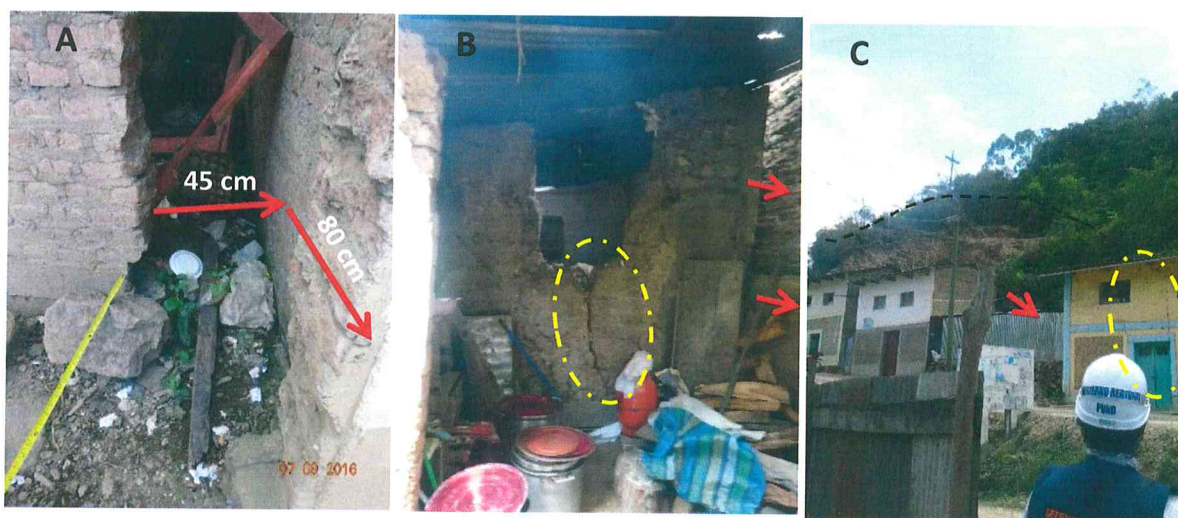
Foto 05. A. Desplazamientos de muros de vivienda en 2 direcciones. B. Agrietamientos y desplazamiento de muros. C. Vivienda colapsada. En líneas punteadas negras se observa escape de deslizamiento.
