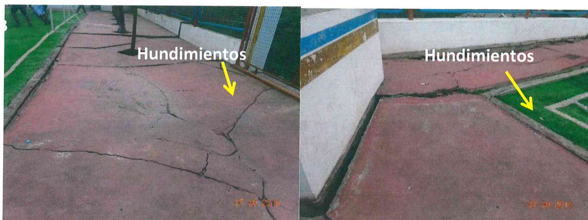
Foto 22. A y B. Agrietamientos producto del hundimientos en las veredas y cancha de futbol.
