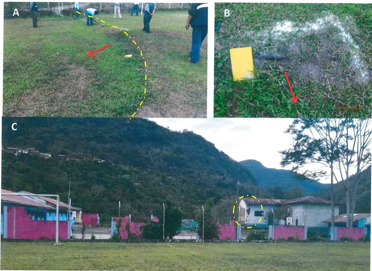
Foto 23. A y B. Hundimientos en Estadio Municipal. C. Daños en muros de adobe del C.E. Centro Base.
