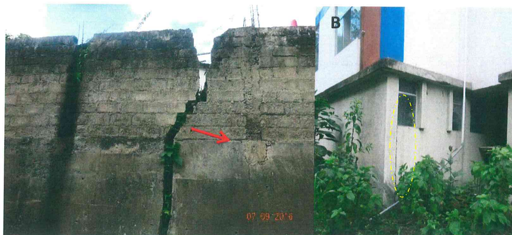
Foto 15. A y B. Agrietamientos verticales en paredes del Centro de Salud.
