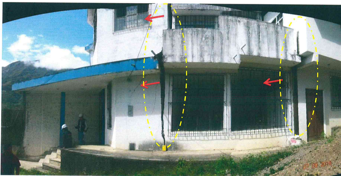
Foto 01. Vista externa del C.E. Santa María de Providencia Fe y Alegría. Nótese los agrietamientos que afectan la fachada. Parte superior, separación horizontal de muros. Las flechas rojas indican la dirección de desplazamiento de muros debido a la activación del deslizamiento.
