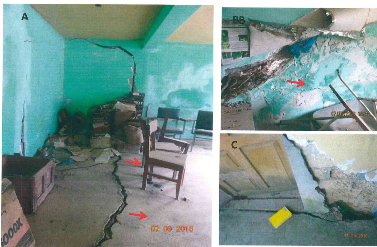
Foto 18. A. Grietas en piso (Apertura: 5 cm, Largo: 15 m) B y C. Rajaduras con desplazamientos de muros de material noble. (SECOVASA)
