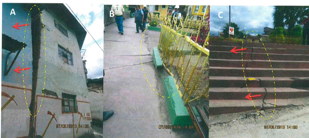
Foto 12. A. Muros de adobe desplazados (Hasta 30 cm). B y C. Rupturas de cerco de jardines y graderías de la Plaza de Armas.
