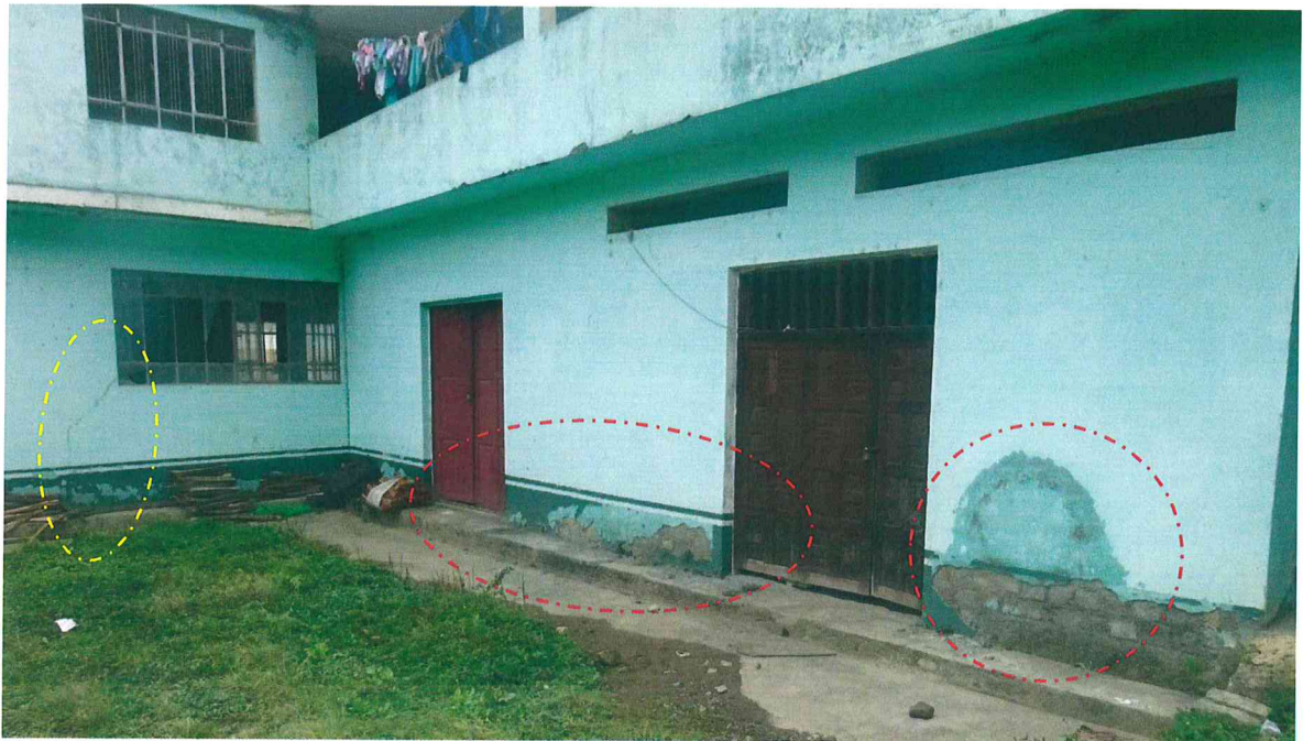
Foto 20. En amarillo, fisuras leves. En rojo, alta presencia de humedad.
