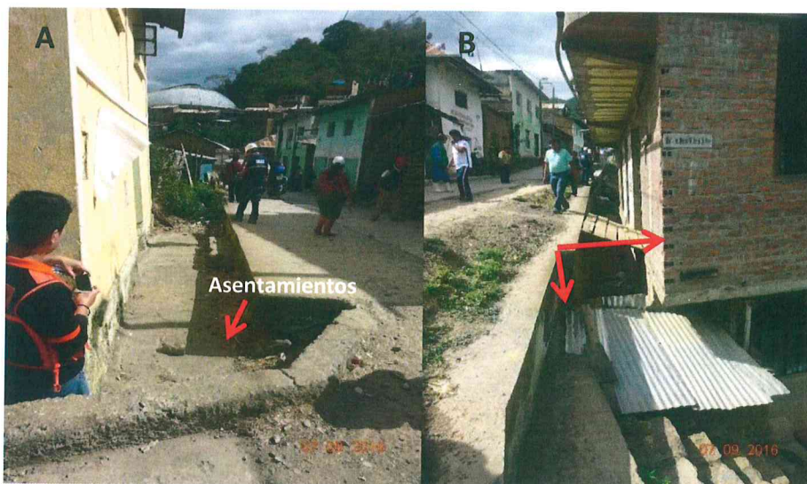
Foto 07. A. Asentamientos en viviendas B. Asentamientos (0.8 m) y desplazamientos horizontales hasta de 1.15 m. (Jr.Sandia)
