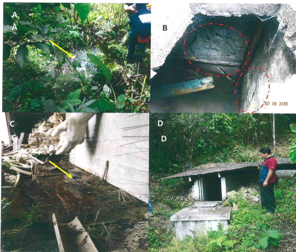
Fig. 13. Emanaciones de agua de naturaleza subterránea. A. Surgencia de agua en terrenos cercanos al C.E. Santa María Providencia B. Tanque de captación de aguas subterráneas con daños estructurales en sus muros. C. Emanaciones de aguas en zonas internas del mercado de San Juan del Oro D. Zona de captación de aguas subterráneas.
