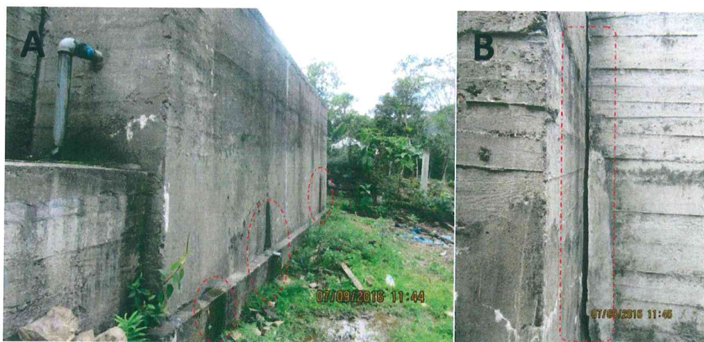
Ver Fig. 16. A. Puntos de filtración de agua del reservorio que abastece de agua. B. Desplazamiento del muro del reservorio.
