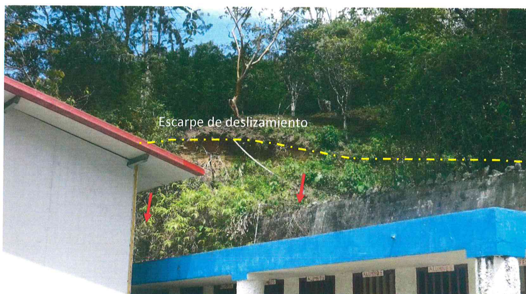
Fig. 06. Escarpe antiguo de deslizamiento en proceso de activación (En líneas punteadas). Representa un peligro muy alto para el Centro Educativo.
