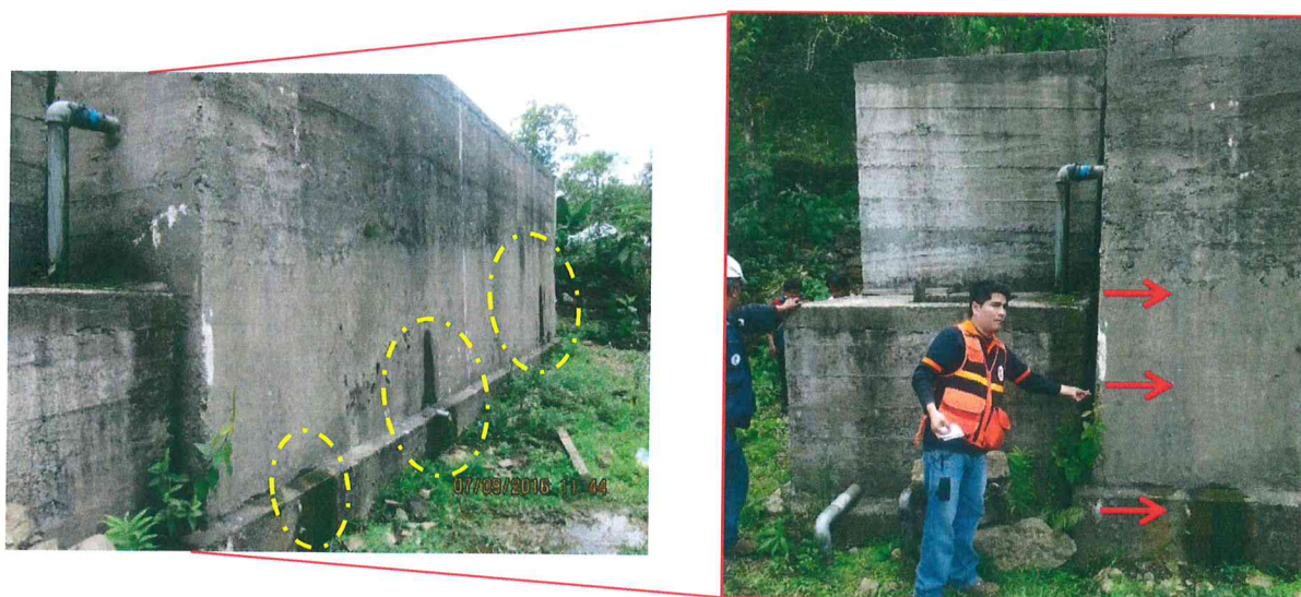
Foto 04. Los círculos punteados muestran puntos de filtración de agua del reservorio. Las flechas rojas indican el desplazamiento de los muros del reservorio.
