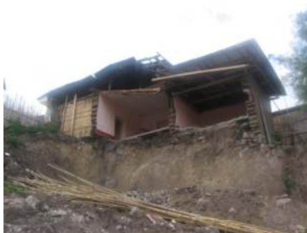
Fotos 6 y 7: Desprendimiento y desplazamiento de SS. HH de la vivienda
