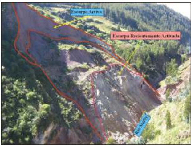
Foto 8. Quebrada Saphy mostrando deslizamientos antiguos y recientes
