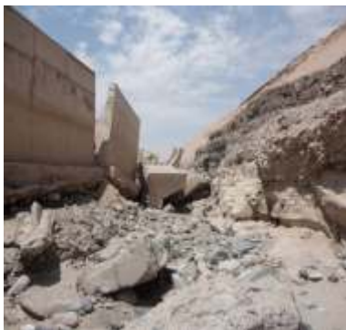
Foto N°01. La vista muestra el colapso de los muros en la zona del lecho inactivo progresivas 0+670 y 0+680 se calculó un incremento de base de lecho de 1,61m
