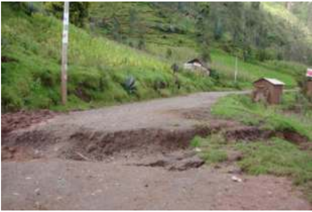
Foto 1 y 2: Presencia de grietas en la parte alta de la comunidad de Choquepuquio
