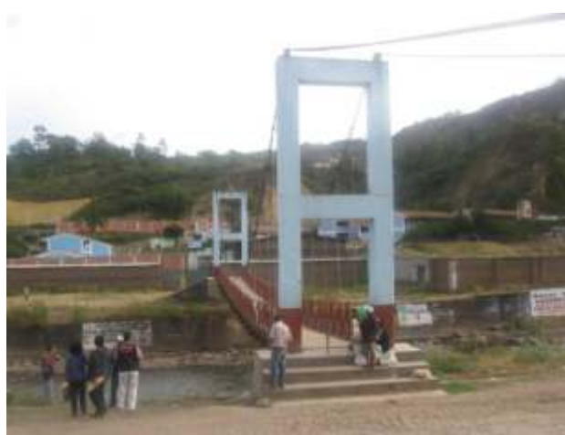
Foto 8: Puente peatonal afectado, el cual posteriormente ha sido desmontado
