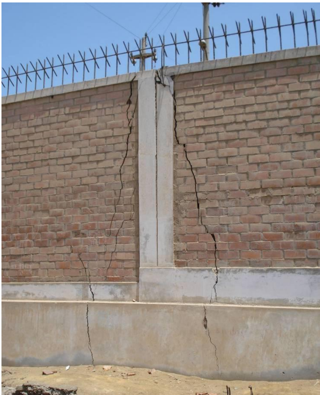
Fotos 03 y 04. Agrietamientos en dirección de la escarpa principal en la Institución Educativa 20325-Manzanares (foto: INDECI – Huacho).
