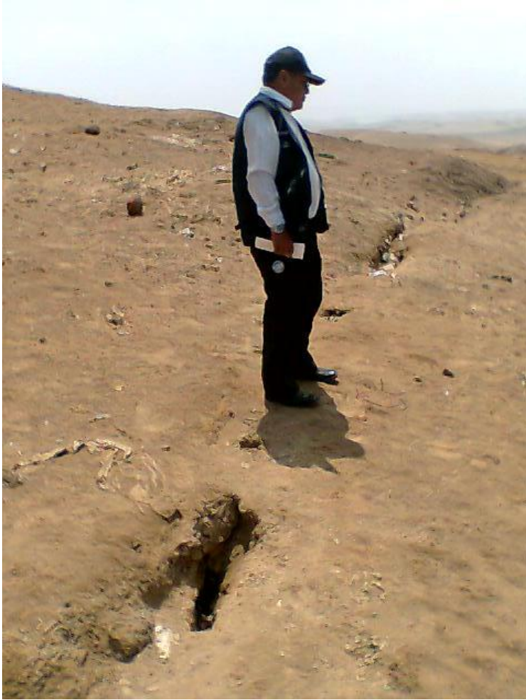
Foto 03. Agrietamientos en el cuerpo del deslizamiento. Vista al NO. (foto: INDECI – Huacho)
