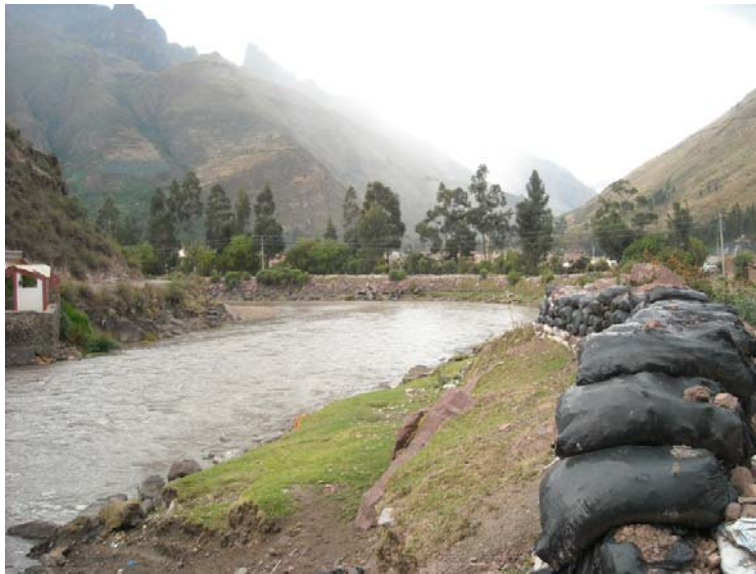
Figura 15: Defensa ribereña en el río Urubamba. En febrero del 2010 las fuertes lluvias incrementaron el nivel del río, llegando a sobrepasar el nivel del enrocado e inundar todas las viviendas y áreas de cultivo.
