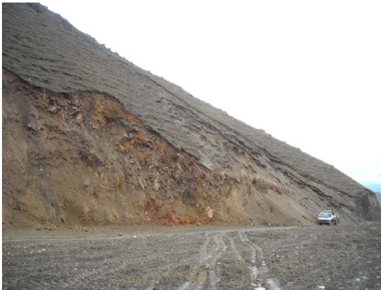
Figura 5: Formación de deslizamientos debido al corte de talud y ampliación de la carretera Calca-Lares
