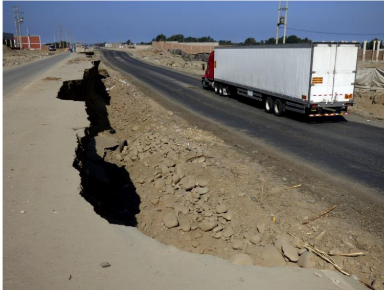
Foto 41. Erosión fluvial en la carpeta asfáltica en la vía circunvalación de la ciudad de Trujillo. Distrito Huanchaco.
