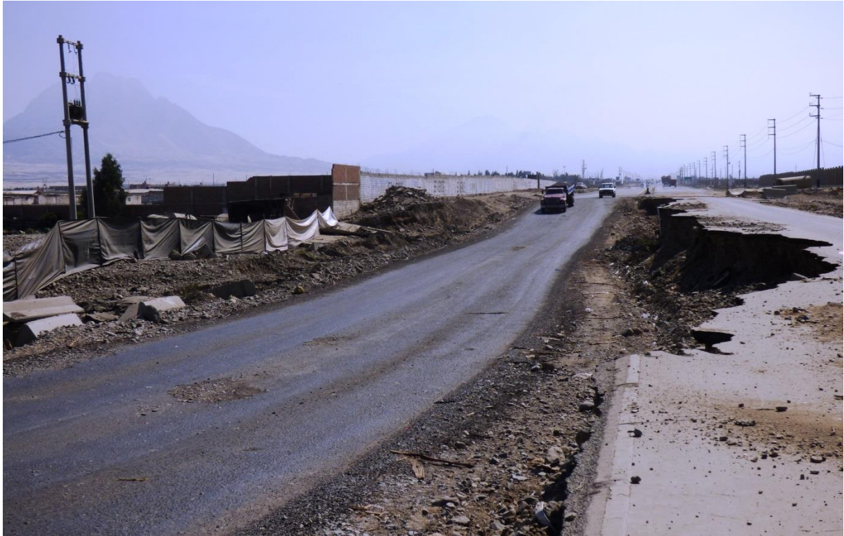
Foto 18. Erosión en la carpeta asfáltica de la Vía de Evitamiento (vía auxiliar de la Panamericana Norte) en la ciudad de Trujillo. Distrito Huanchaco.
