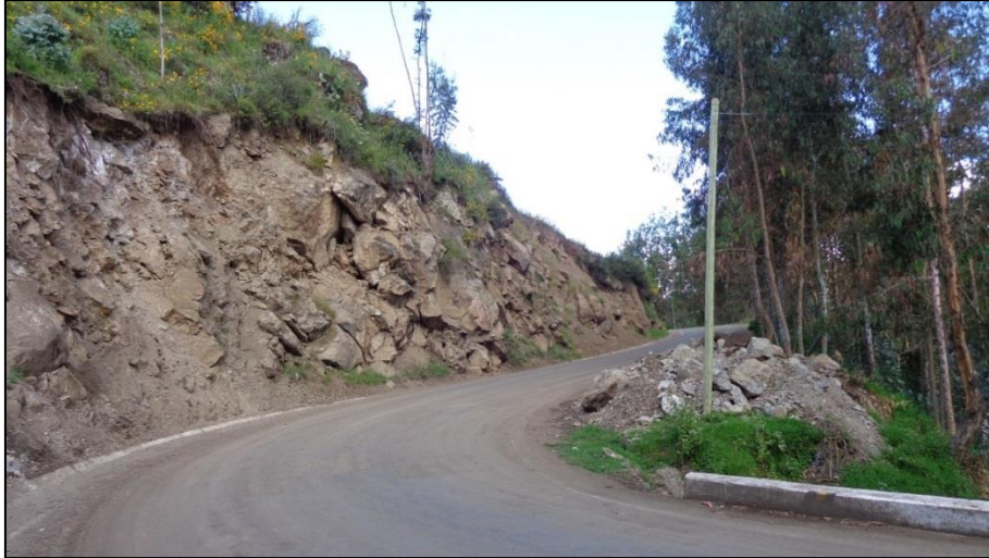
Foto 47. Vía hacia Santiago de Chuco, se puede observar restos de material colapsado, que provocaron el bloqueo de la vía Quebrada Chulite, distrito de Santiago de Chuco. Vista al Este.
