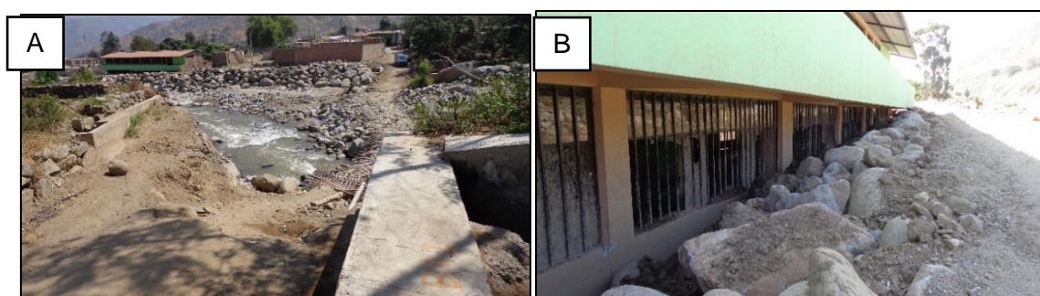
Foto 31. A) Fotografía panorámica del río La Cuesta. La crecida del río ocasionó daños en tuberías de agua potable e inundó las viviendas aledañas, así también causó la destrucción de camino rural. Vista al SO. B) Local multiusos del Pedregal afectado por la inundación a causa del desborde del río La Cuesta, obsérvese el nivel del material arrastrado por la corriente del río. Localidad del Pedregal, distrito Simbal. Vista al Sur.
