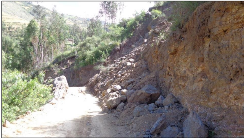
Foto 48. Derrumbes que provocaron el bloqueo de la vía, originadas por el fracturamiento, meteorización y las precipitaciones pluviales. Localidad Carnachique, distrito Otuzco. Vista al Norte.
