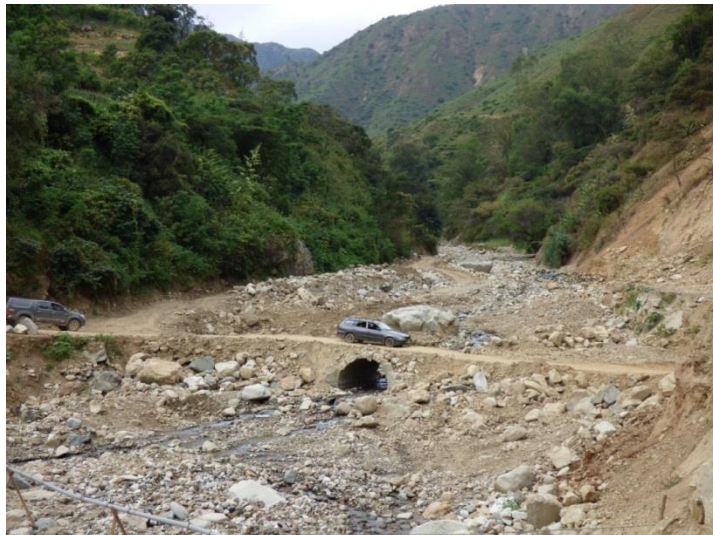
Foto 39. Flujo de detritos excepcional sobrepasó la capacidad del puente en la quebrada Chimbiles, carretera Cascas – Contumazá. Distrito Cascas, provincia Gran Chimú, La Libertad.
