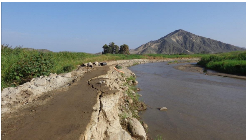
Foto 45. Trocha carrozable inhabilitada a causa de la erosión fluvial provocada por el río Huamanzaña. Hacienda Laramie, distrito Chao. Vista al NO.
