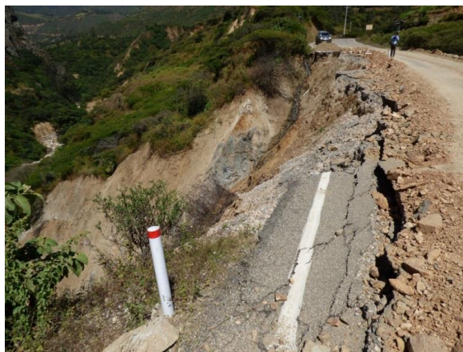
Foto 37. Derrumbe en el talud inferior de la carretera Chilete – Contumazá. Sector Nansha, distrito y provincia Contumazá, Cajamarca.
