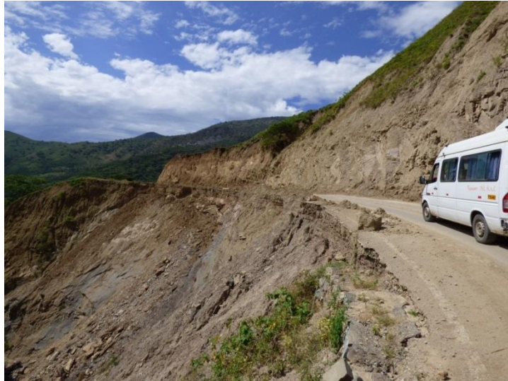
Foto 38. Derrumbe en el talud inferior de la carretera Chilete – Contumazá; Sector Santa Rosa del Rupe, distrito Chilete, provincia Contumazá, Cajamarca.
