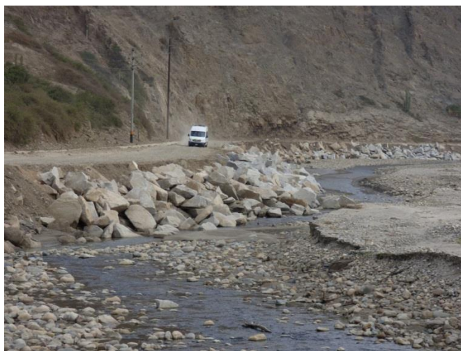
Foto 40. Rehabilitación parcial de la carretera Chicama-Cascas después de la erosión fluvial en la margen izquierda del río Chicama. Distrito Chicama, provincia Ascope, departamento La Libertad.
