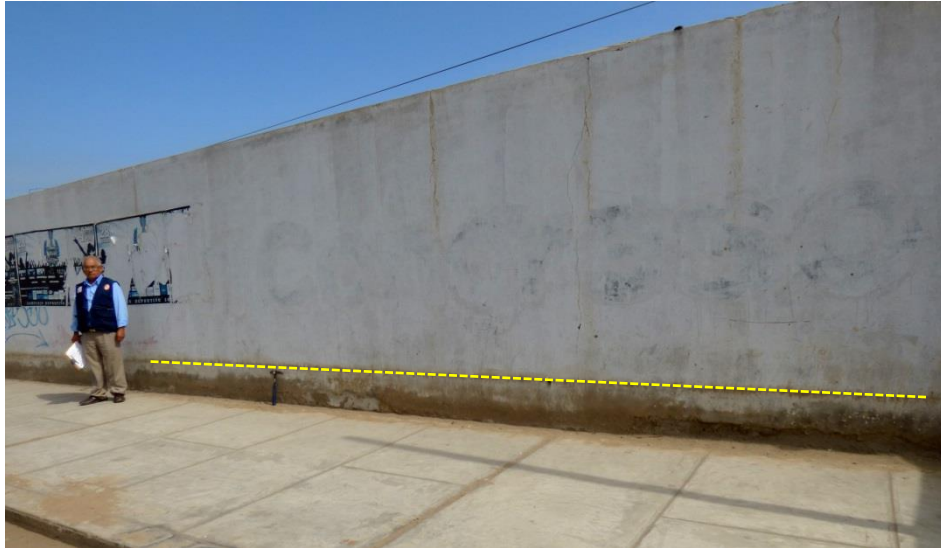
Foto 24. Rastros de nivel de agua alcanzada por inundación en las calles del distrito Víctor Larco Herrera; provincia Trujillo, La Libertad.
