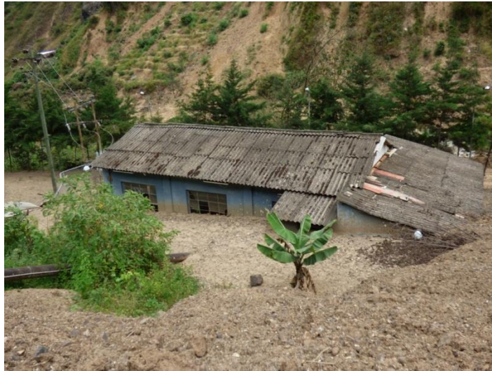
Foto 51. Mini central hidroeléctrica en desuso afectado por flujos provenientes del cerro Rumán en el distrito Cascas, Provincia Gran Chimú, La Libertad.
