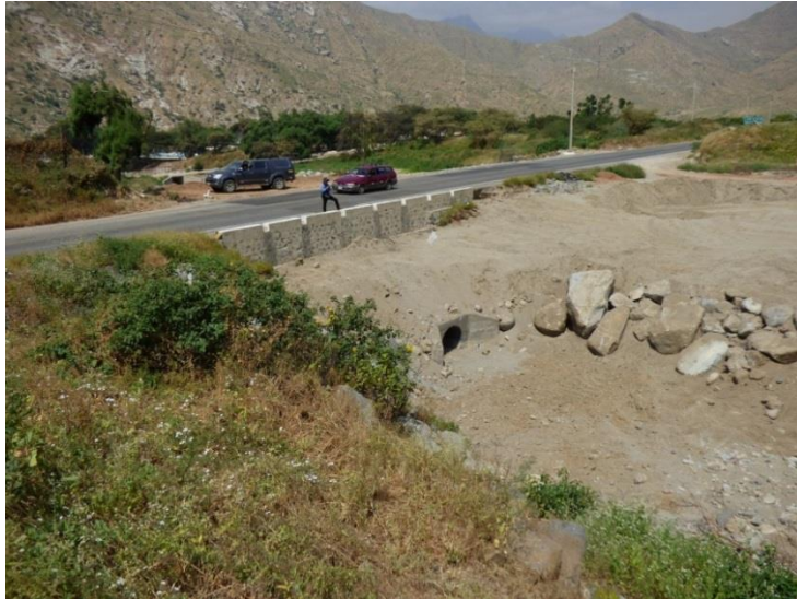
Foto 35. Alcantarilla de dimensiones inadecuadas que fue cubierto por flujos provenientes de la quebrada Las Viejas. Distrito Yonán, provincia Contumazá, Cajamarca.
