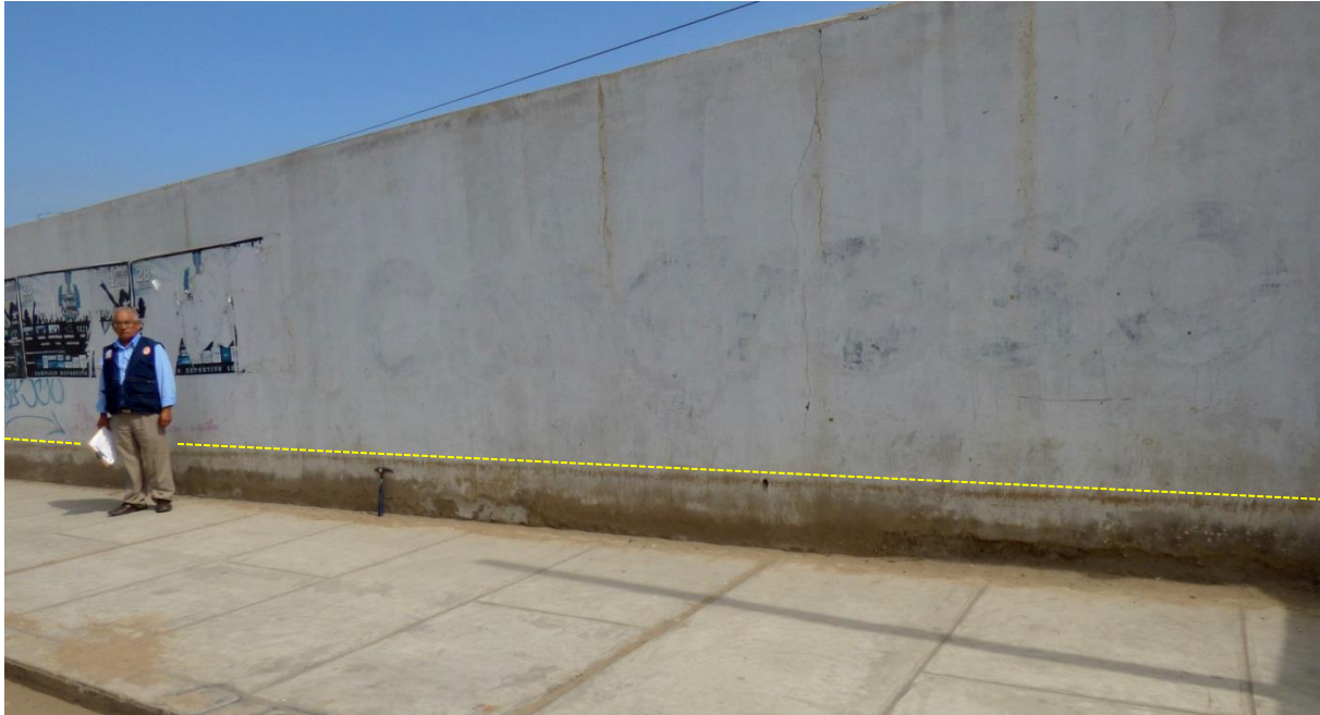
Foto 15. Nivel de agua alcanzado (línea discontinua) durante el Niño Costero en las calles del distrito Víctor Larco Herrera; ciudad de Trujillo.
