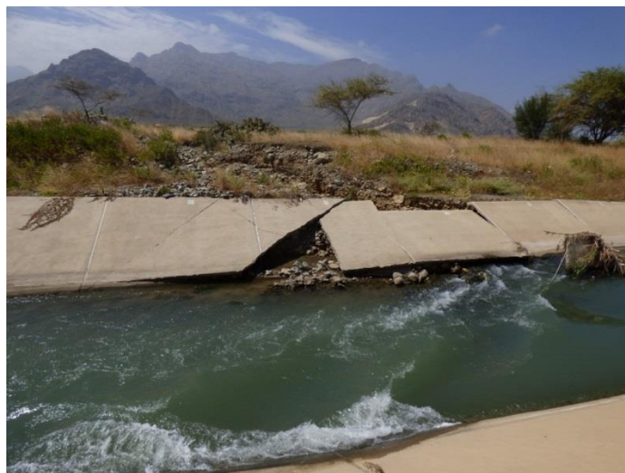
Foto 52. Erosión fluvial que afectó canal de riego Jequetepeque – Zaña en el sector Morona Alta. Distrito y provincia Chepén, La Libertad.
