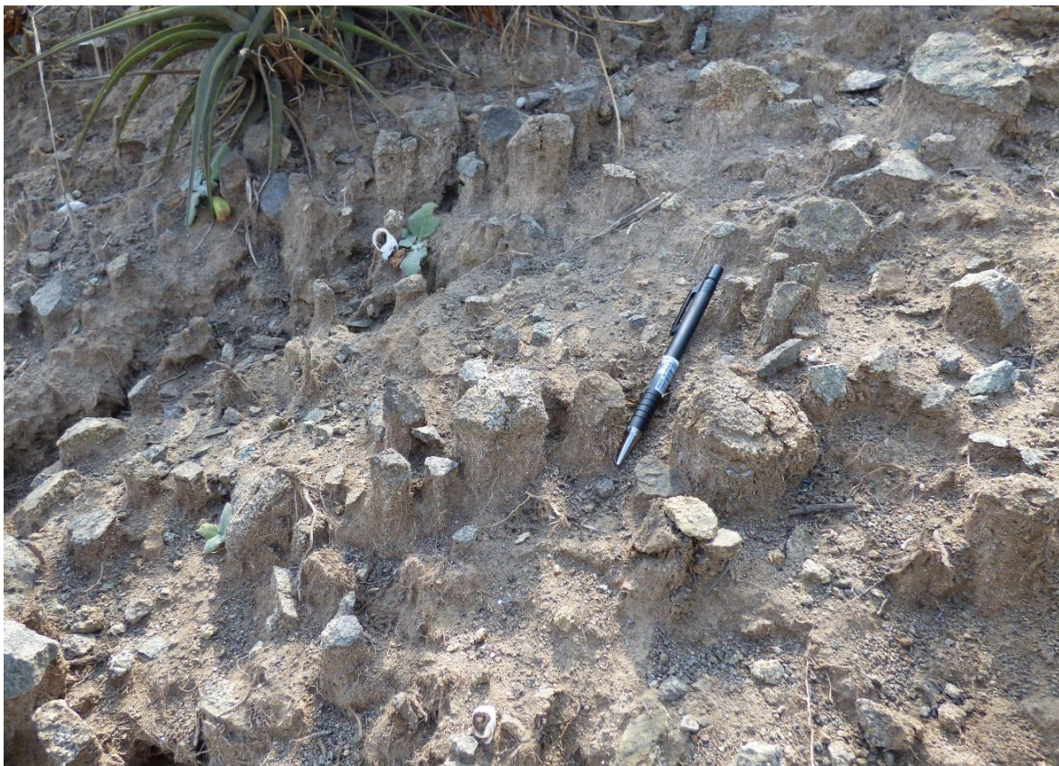
Foto 9. Erosión pluvial sobre suelos en las laderas del cerro San Idelfonso.
