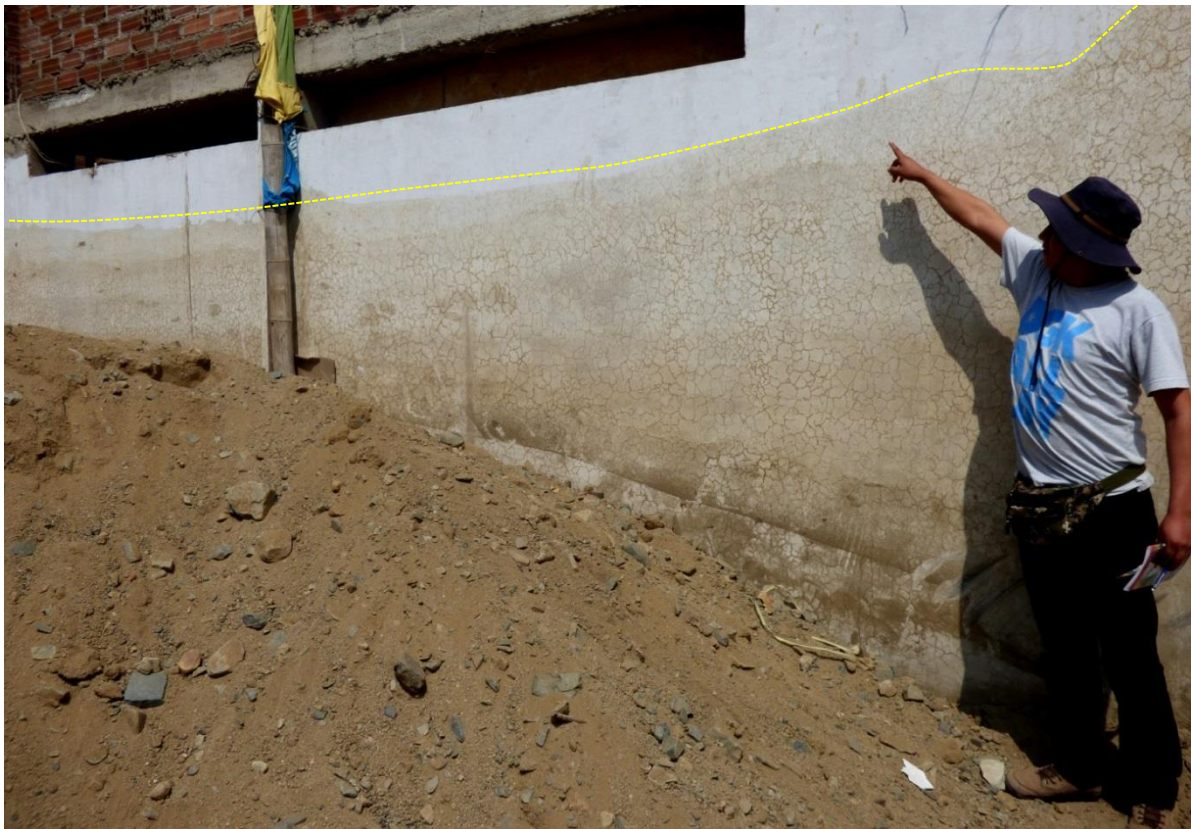
Foto 14. Nivel de agua alcanzado durante el Niño Costero (línea discontinua) en calles del distrito El Porvenir, Trujillo.
