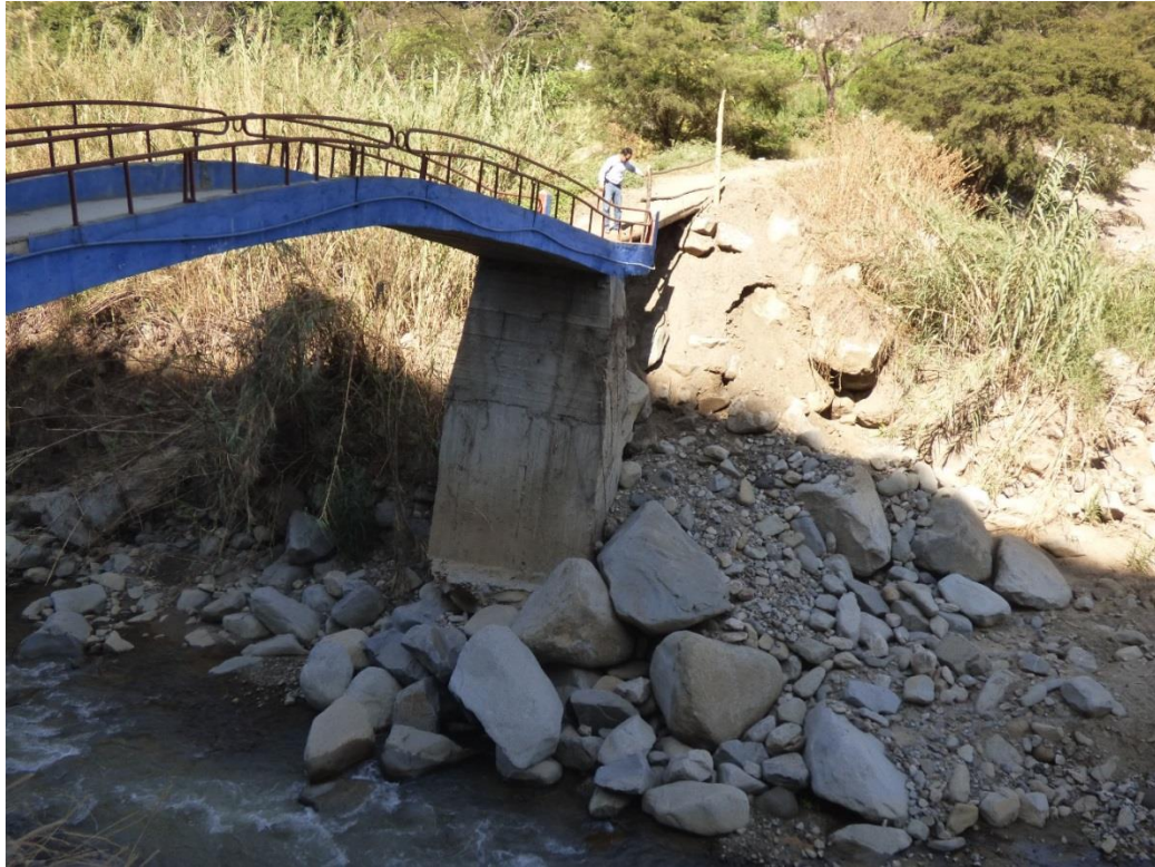
Foto 53. Puente peatonal afectado por la erosión fluvial en el distrito Cascas, provincia Gran Chimú, La Libertad.
