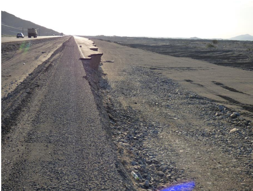
Foto 42. Erosión fluvial de la carpeta asfáltica en el Km 661, carretera Panamericana Norte. Distrito de San Pedro de Lloc, provincia Pacasmayo, La Libertad.
