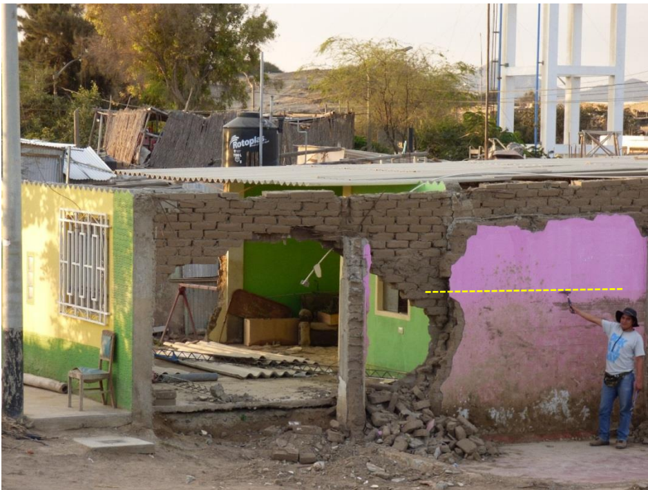
Foto 23. Rastros del nivel de agua alcanzada por la inundación fluvial en los asentamientos humanos Cacique de Lloc y Ontere Giura. Distrito San Pedro de Lloc, provincia Pacasmayo, La Libertad.
