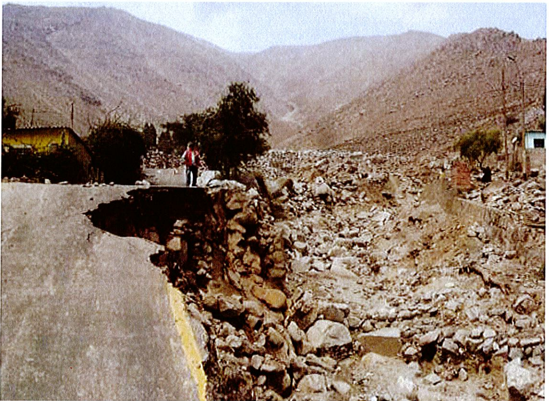
Foto 25. Erosión en el cauce de quebrada en el inicio de canalización al ingresar a la zona de viviendas. Se aprecia el ancho y profundidad insuficientes para un paso de huayco, gran acumulación de bloques subangulosos de diferentes tamaños, en el cauce.
