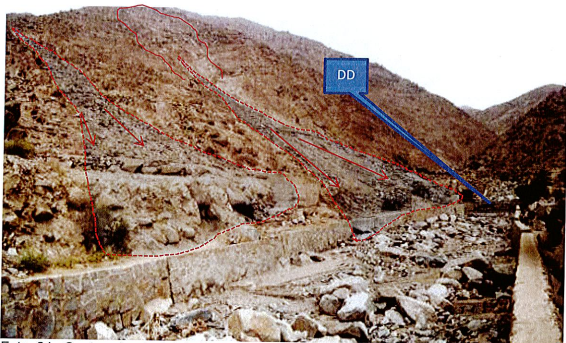
Foto 21. Sector donde inicia la canalización de la quebrada; se distingue también diques disipadores (DD), los cuales se encuentran colmatados con grandes bloques rocosos.
