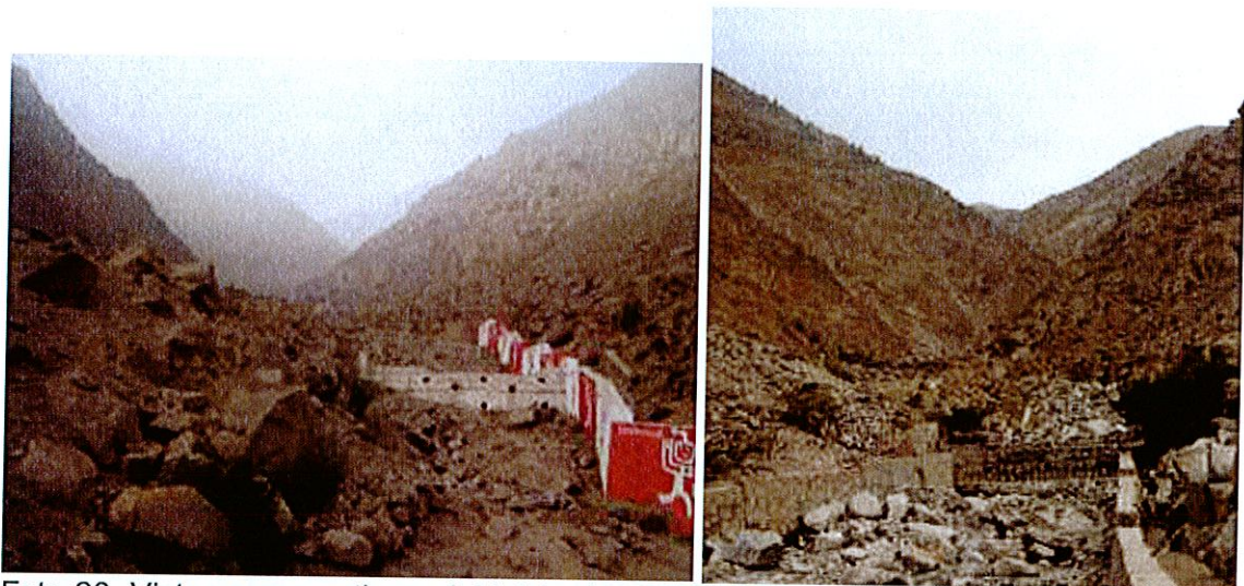
Foto 20. Vistas comparativas del inicio de canalización y diques tomado el 2008 (foto izquierda) y el 2012 (foto derecha) en la quebrada Santo Domingo. Se nota la colmatación de dichas estructuras por el reciente flujo.
