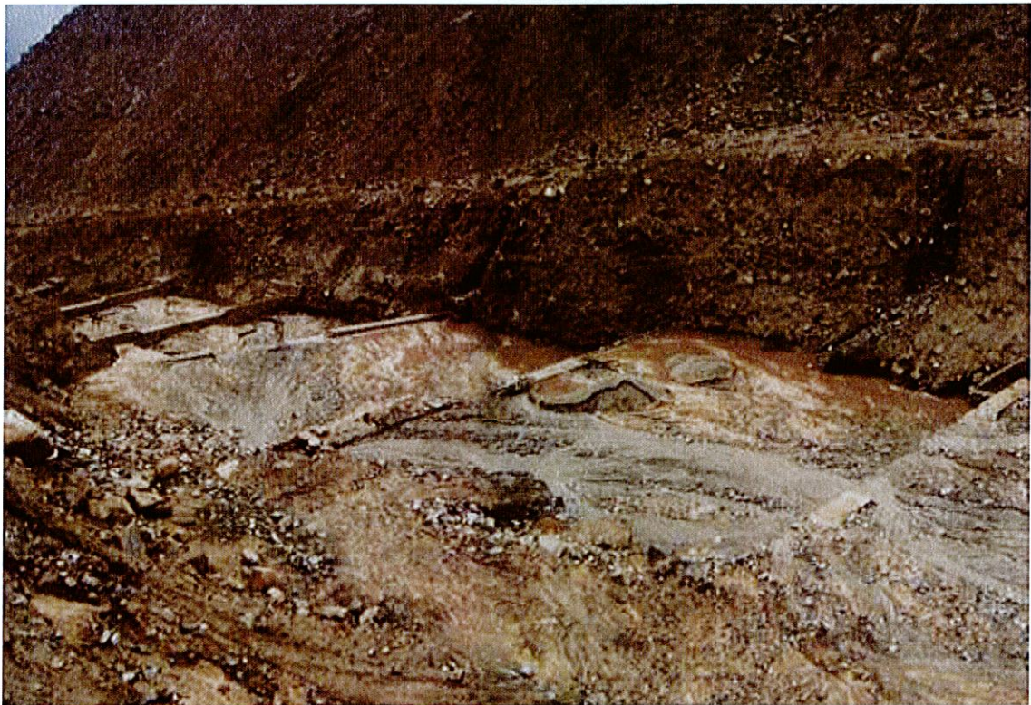
Foto 30. Detalle de un sector de tres de las estructuras transversales dispuestas en la quebrada La Ronda que muestra una colmatación total con sedimentos y material de huayco acarreado durante lluvias estacionales (escorrentía normal) y lluvias recientes excepcionales.
