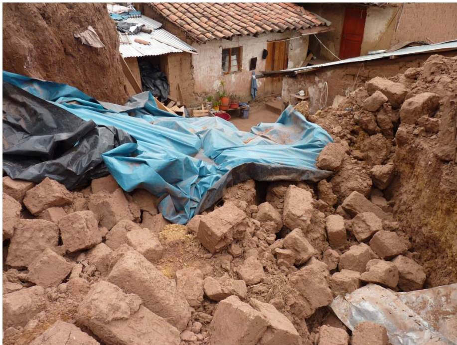
Fig. 7: Vivienda de la calle Cruz Pata parcialmente destruida por el deslizamiento.
