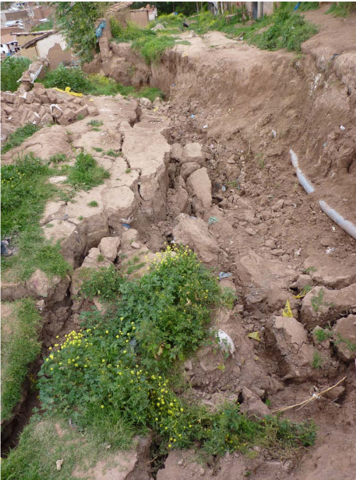
Fig. 8: Se aprecia que la tubería de agua potable se encuentra exactamente en la zona de arranque del deslizamiento, expuesta en la escarpa.
