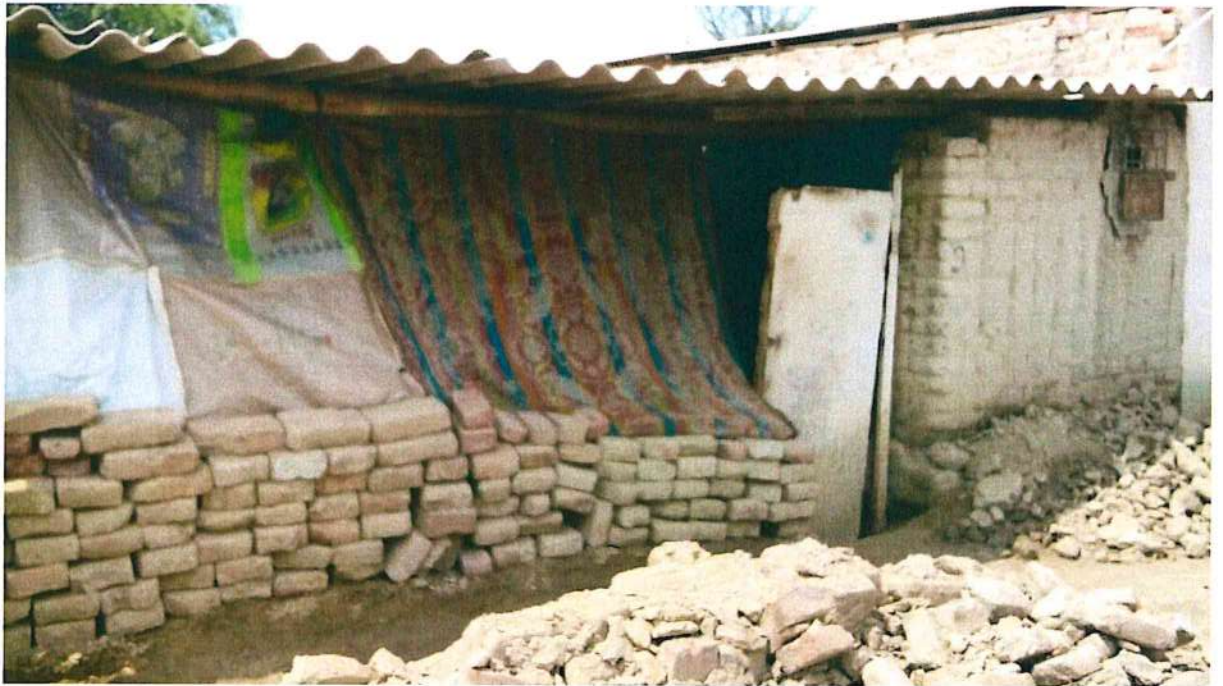
Vivienda de adobe donde colapsó una pared
