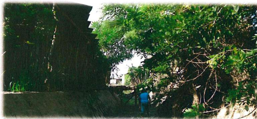
Foto N° 8, 9, 10: Drenes colmatados y con vegetación
