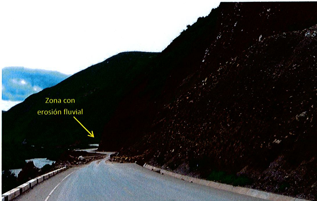
Foto 9: Derrumbes desde el talud superior en el punto Hcy-104, compromete depósitos coluviales y rocas calcáreas alteradas. También se señala con flecha amarilla el talud inferior de carretera afectado por el proceso de erosión fluvial.
