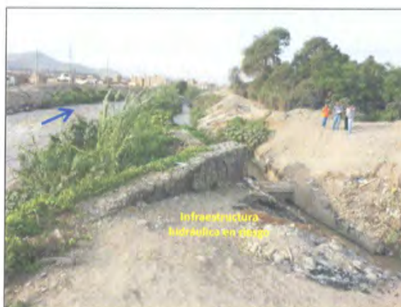
Figura 11. Punto crítico en el sector Pro, infraestructura de riego en riesgo
