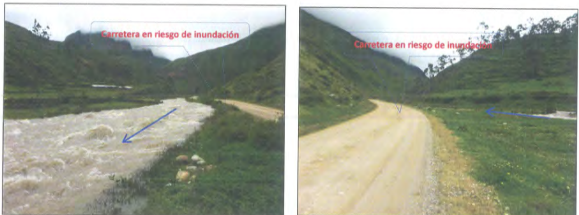
Figura 1. Carretera Carabaylo-Canta en riesgo de inundación y erosión del río Chillón
