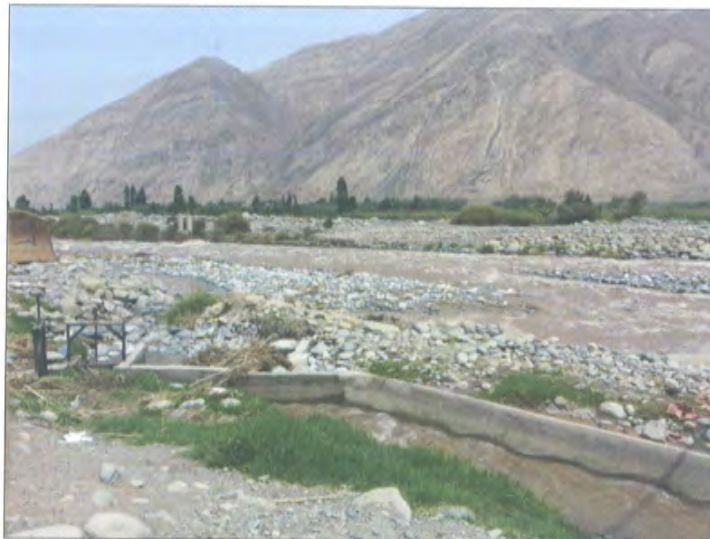
Figura 6. Captación directa para riego: se observa falta de mantenimiento
