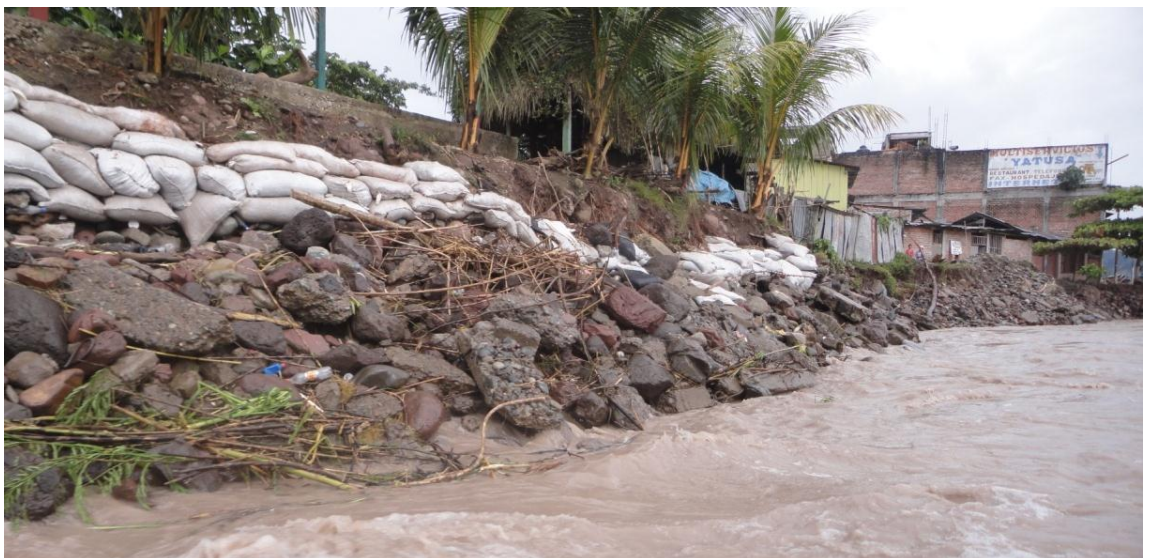
Foto 13.-Defensa ribereña conformada por sacos de arena y arrimado de material (desmante).
