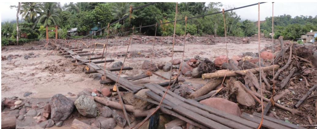
Foto 24.- Puente peatonal parcialmente destruido.
