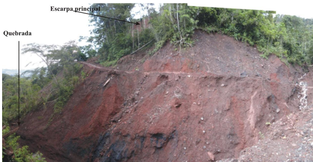
Foto 26.- Deslizamiento que afecta la carretera afirmada Sivia-Balsamuyocc.
