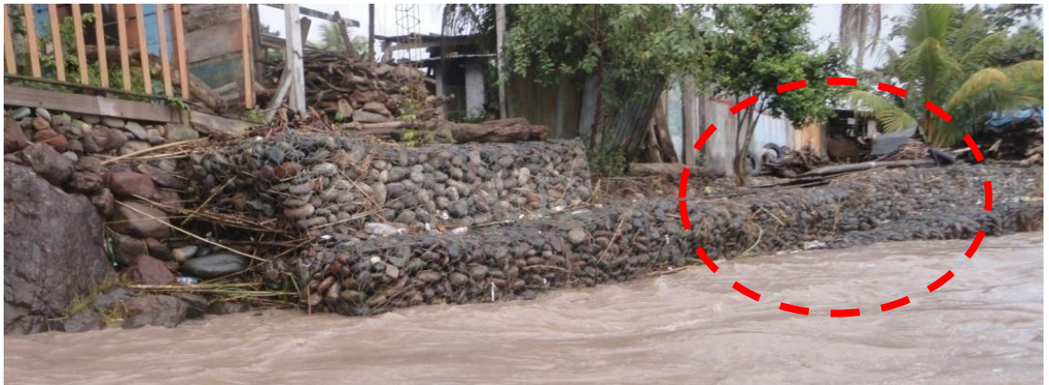
Foto 12.- Defensa ribereña conformada por enrocado y gavión, se muestra el área afectada.
