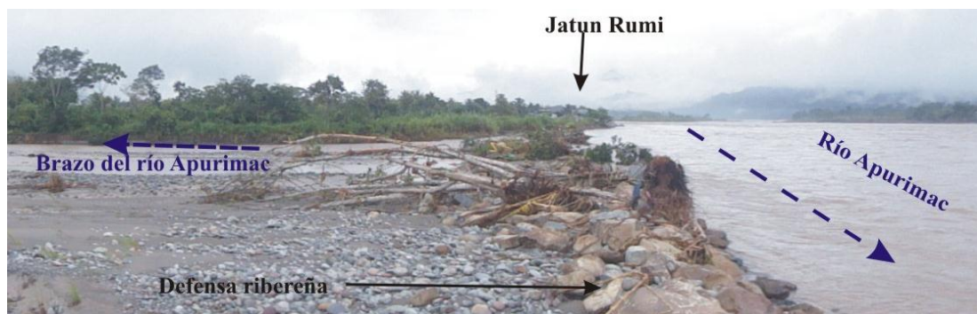
Foto 17.- Aguas abajo del antiguo poblado de Jatun Rumi, se muestra la defensa ribereña parcialmente destruida.
