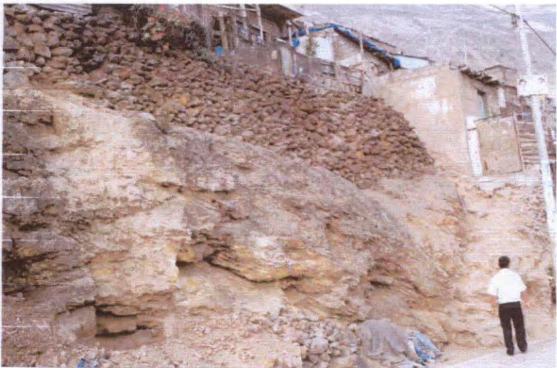
FOTO N° 2: Zona donde se encuentra la roca alterada, obsérvese casas construidas sobre un relleno inadecuado (limite del A.A.H.H. 07 de Octubre con el A.A.H.H. Amauta).
