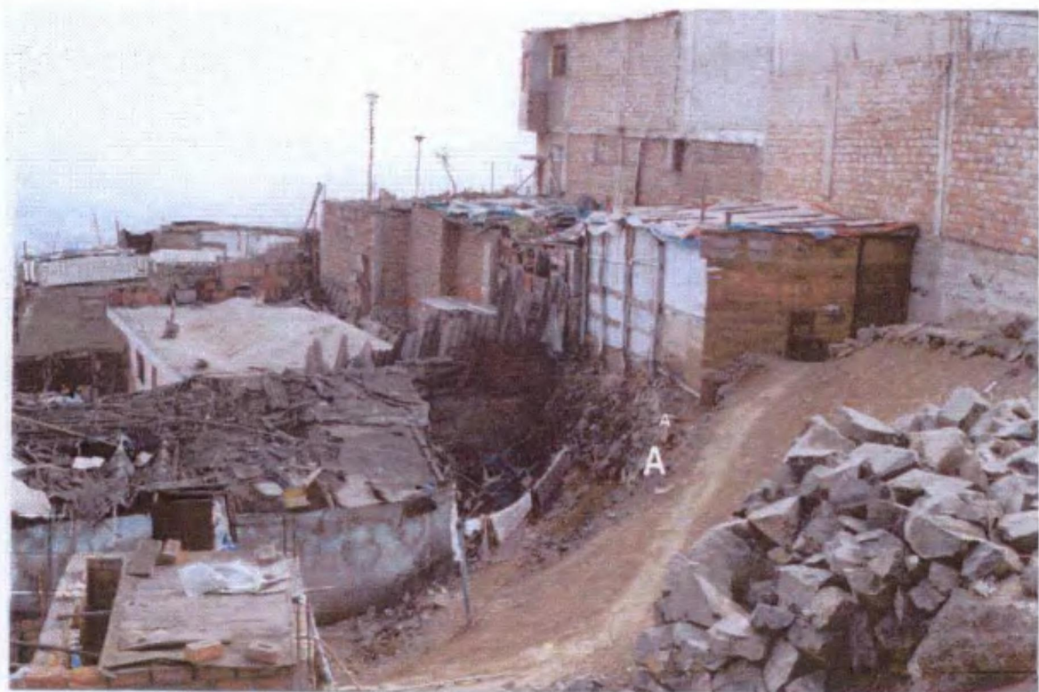
FOTO N° 6: Viviendas de construcción precarias (Zona 4), que carecen de buenos cimientos. Se aprecia material de relleno en sus bases (A).
