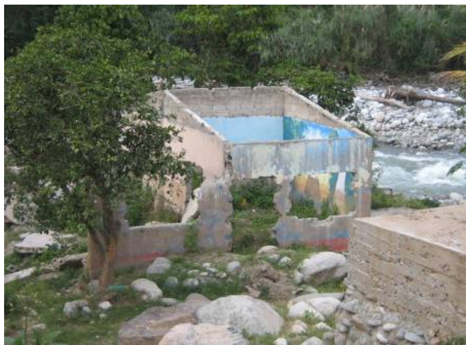
Foto N° 77 : Vivienda destruida en Malecón Tarma por el flujo de lodo y detritos de la Qda. HUacará.
