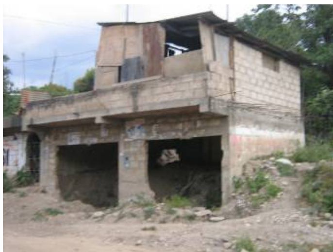
Foto N° 17 : Vivienda afectada por desastre del 22.01.2007 A.H. Juan Pablo II
