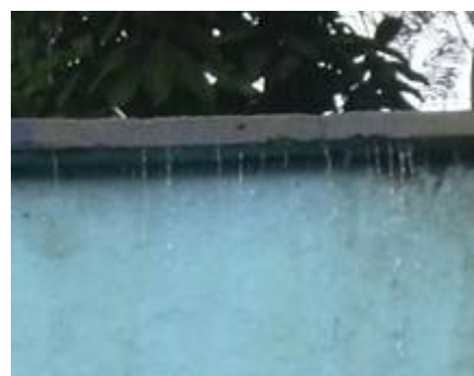
Foto N° 28 : Pérdidas de agua en reservorio
