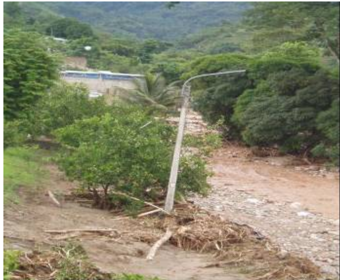
Foto N° 34: Poste por caer en la localidad de Huacará.
