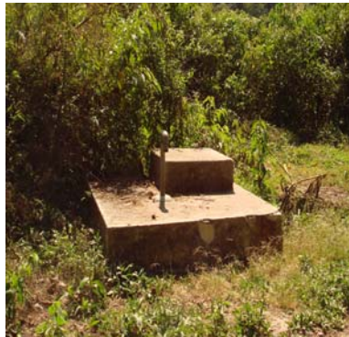
Foto N° 20 : Cámara Rompe Presión N° 1
