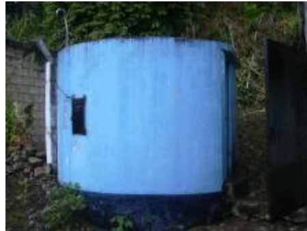
Foto N° 30 : Pozo artesiano Nueva Vista
