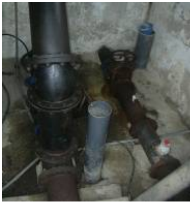
Foto N° 25 : Caseta de válvulas
