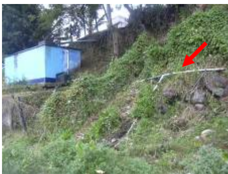
Foto N° 27 : Reservorio y tubería expuesta
