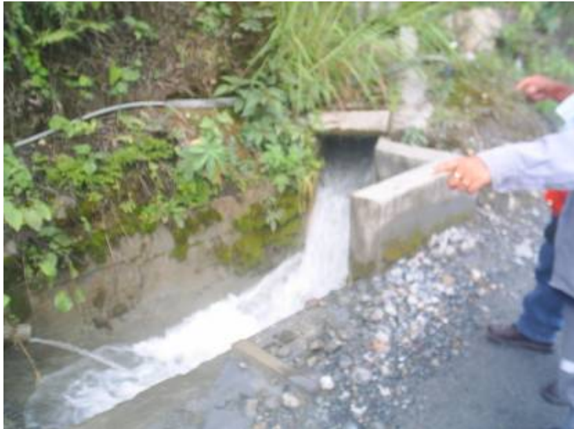
Foto N° 55 : Cuneta de descarga de relaves decantados de SIMSA
