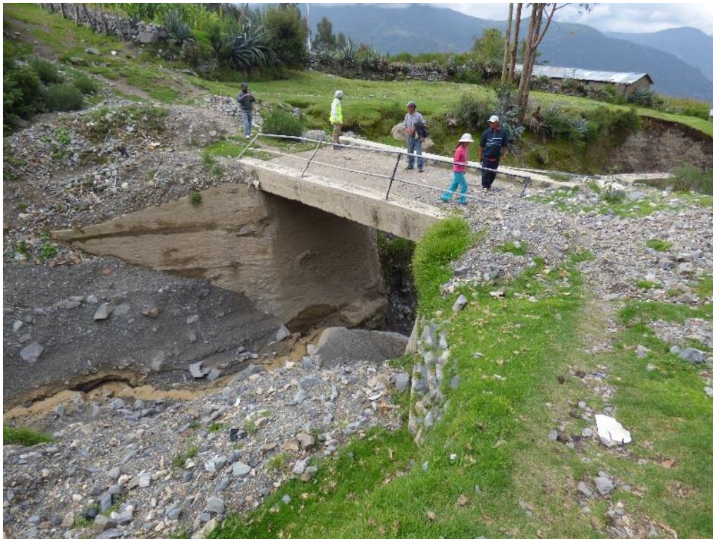
Foto 11. Puente peatonal afectado, por la erosión lateral por el paso del flujo de detritos.
