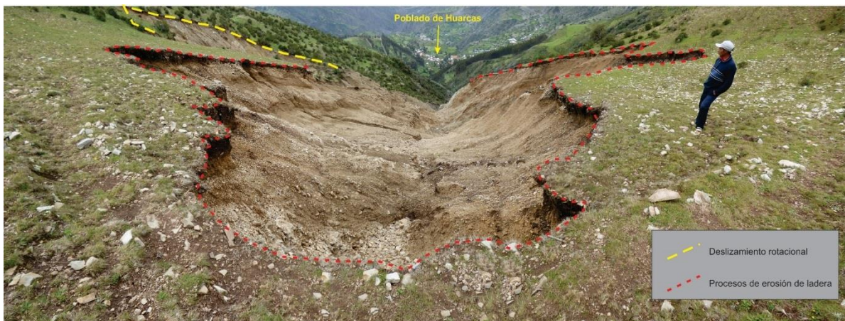
Foto 6. Procesos de derrumbes y deslizamientos en las nacientes de la quebrada.
