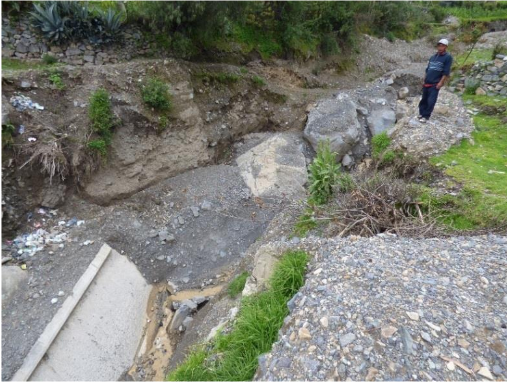
Foto 10. Puente peatonal destruido, por la erosión lateral del paso del flujo de detritos.
