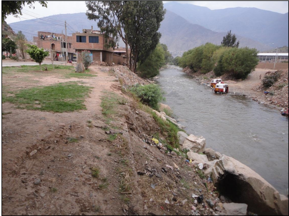
Foto 9.- Margen izquierda del río Higueras, se muestra la defensa ribereña y la acumulación de desmonte y basura.
