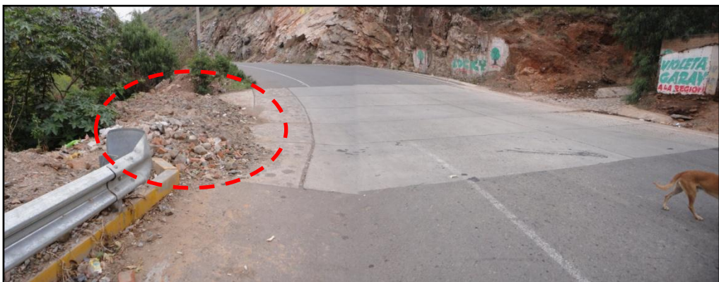
Foto 3.- Badén obstruido por desmorte.
