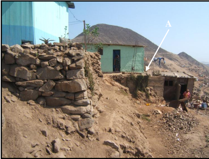
Foto 7.- Manzana B, lote 4, donde ocurrió un derrumbe de pircas (A), actualmente repuesto.
