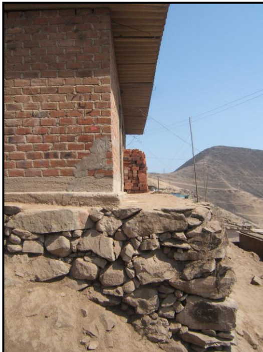
Foto 8.- Vivienda que ha sufrido asentamiento en una de sus esquinas, se observa también que la construcción carece de columnas.
