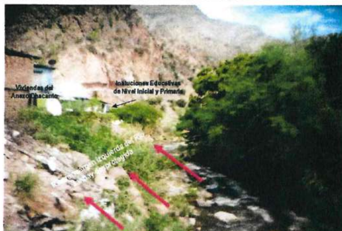
FOTO 2. OTRO TRAMO CRÍTICO DEL RÍO JAHUAY EN DONDE SE OBSERVA EL DEBILITAMIENTO DEL TALUD DE LA MARGEN IZQUIERDA Y RESULTARÍAN AFECTADAS VIVIENDAS Y LAS INSTITUCIONES EDUCATIVAS DE NIVEL INICIAL Y PRIMARIO DEL ANEXO CHACANTO.
