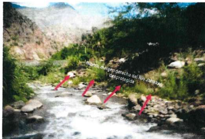
FOTO 1. TRAMO CRÍTICO DE LA RIBERA DE LA MARGEN DERECHA DEL RÍO JAHUAY TOTALMENTE DESPROTEGIDO, QUE ANTE UNA FUERTE AVENIDA SOCAVARÍA EL TALUD DE LA CARRETERA CHACANTO - BALSAS INTERRUMPIENDO EL NORMAL TRÁNSITO ENTRE ESTAS LOCALIDADES.
