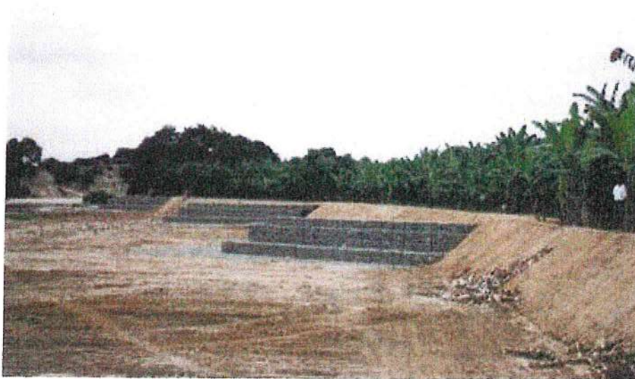
Imagen N° 10: Protección con espigones de gaviones
