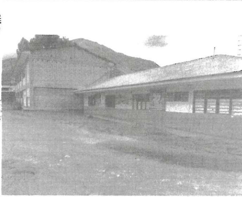
Vista fotografica de la infraestructura publica afectada
