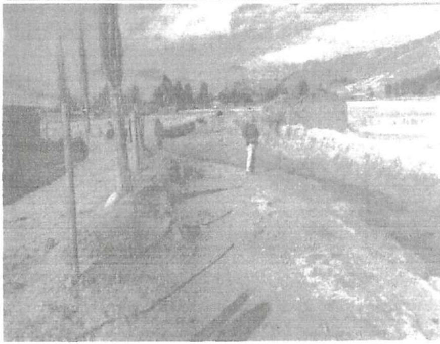
esta fotografía de margen derecha en forma erosión.
