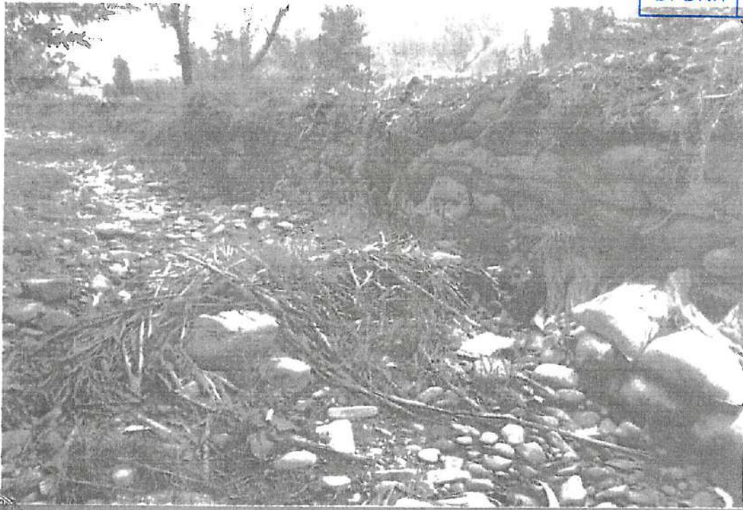
Vista Fotografica del cauce del rio huaru, margenes de rio dañado
