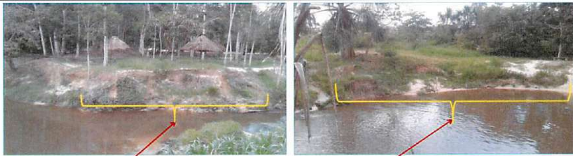
Vistas de la zona erosionada por en el margen izquierdo de la quebrada Zaragoza - Puente Zaragoza.
