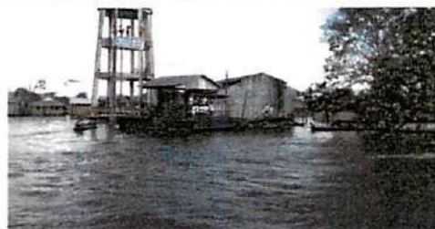
PLANTA DE AGUA CON INFRAESTRUCTURA INUNDADA EN EPOCA DE CRECIENTE
