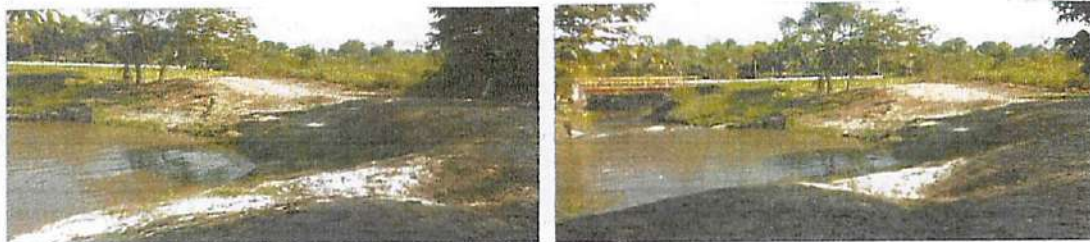
Vistas de la zona erosionada por en el margen izquierdo de la quebrada Zaragoza - Puente Zaragoza.
