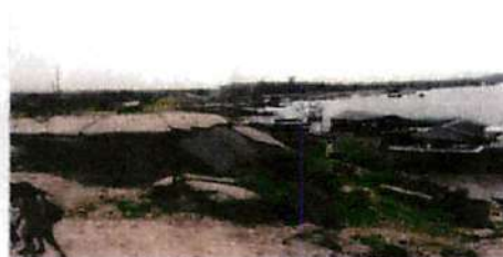
Embarcadero y muros de contención de la Marina deteriorado a causa de las inundaciones y la erosión causada por el río Nanay
