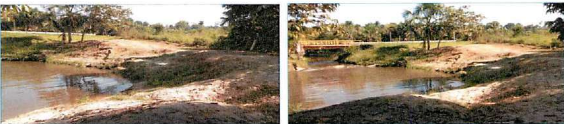
Vistas de la zona erosionada por en el margen izquierdo de la quebrada Zaragoza - Puente Zaragoza.
