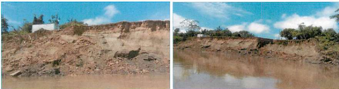
Sectores de la localidad de Augusto Freyre con presencia de erosión en la ribera del río Amazonas- margen izquierdo
