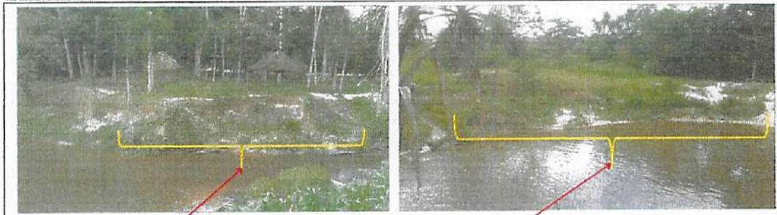
Vistas de la zona erosionada por en el margen izquierdo de la quebrada Zaragoza - Puente Zaragoza.
