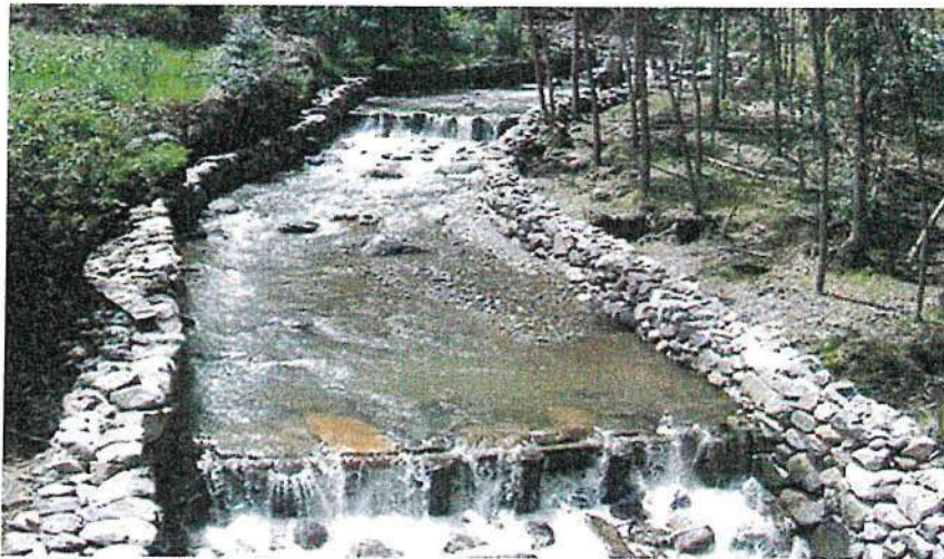
Imagen N° 13: Disipadores de energía en operación ante avenidas
