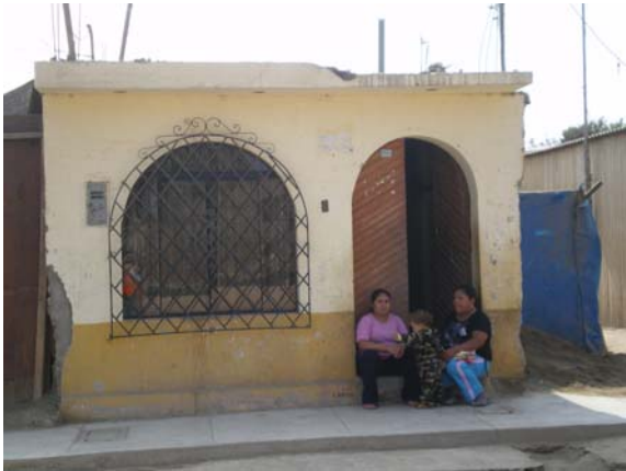
Foto 1.18. Vivienda con daño moderado
