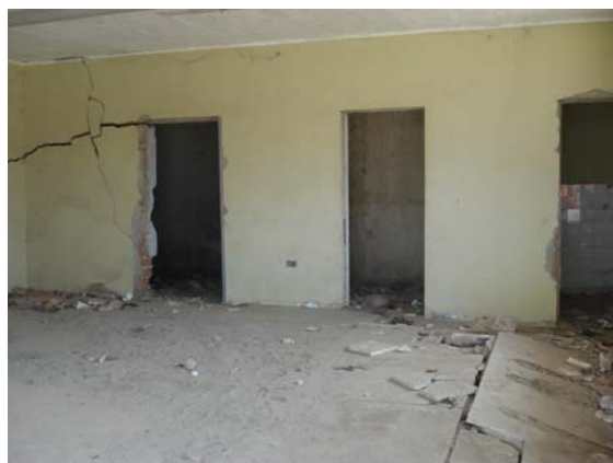
Foto 1.6. Ausencia de dintel
