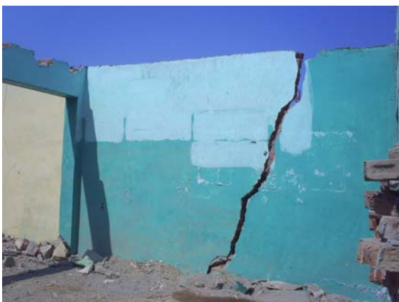
Foto 1.3: Colapso de muros y techo
