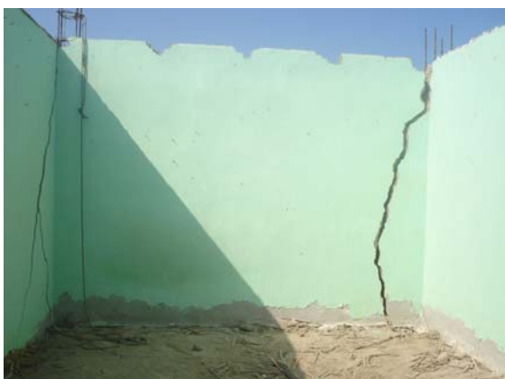
Foto 1.5. Ausencia de viga collar
