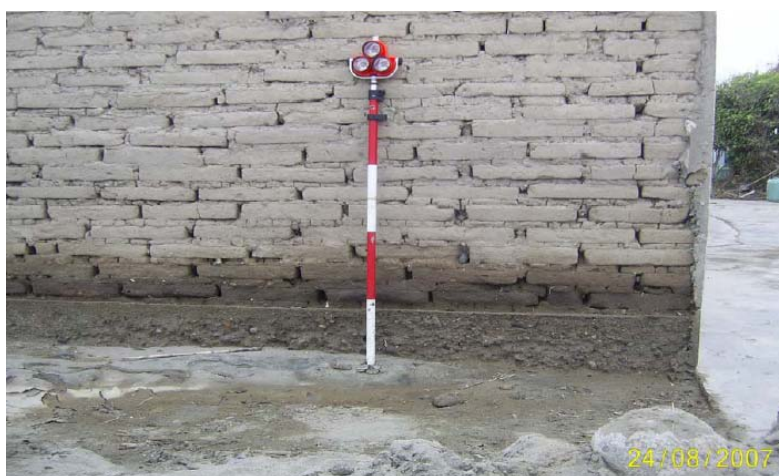
Foto 2.2. Marca de la inundación en muro (DHN)
