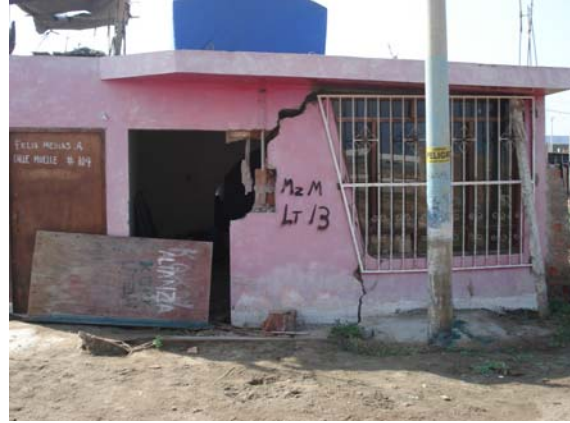
Foto 1.10. Colapso por hundimiento
