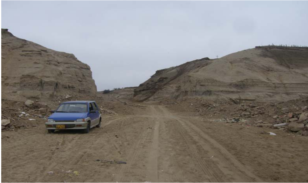
Foto 3.7. Corte en la formación Cañete, donde se observa una discontinuidad de la estratificación de una falla geológica, que esta relacionada con los 6m de arena licuable encontrado en la perforación dinámica del cono Peck (Foto 3.8).
