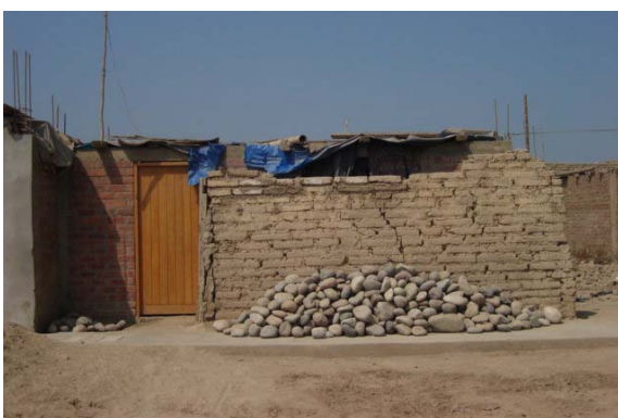
Foto 1.16. Muros de adobe sin solera
