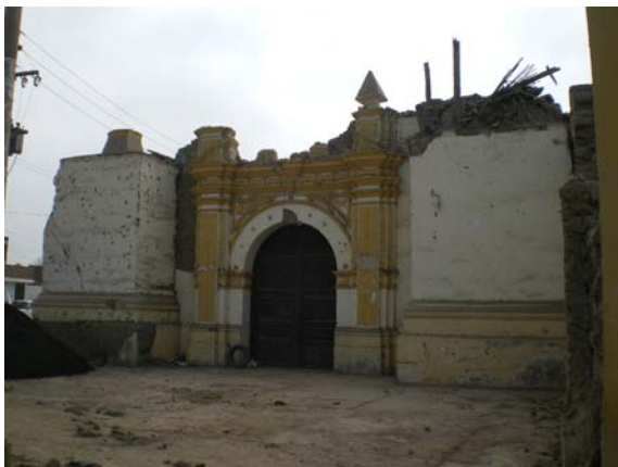
Foto 1.14. Desplome de techo
