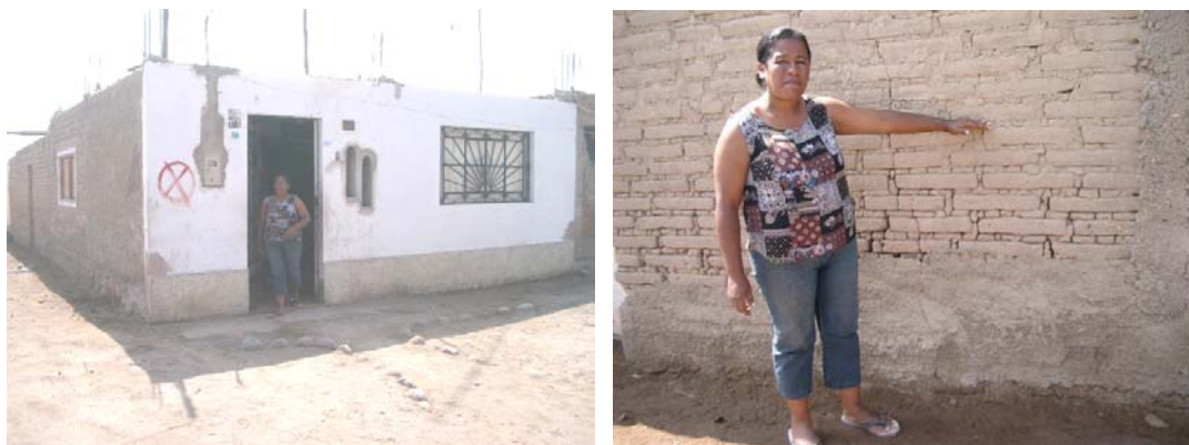
Foto 2.1. Pobladora señala el nivel de inundación que hubo en su vivienda
