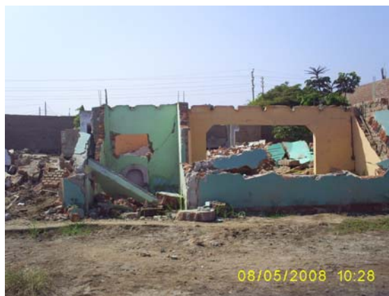
Foto 1.4: Colapso de techo
