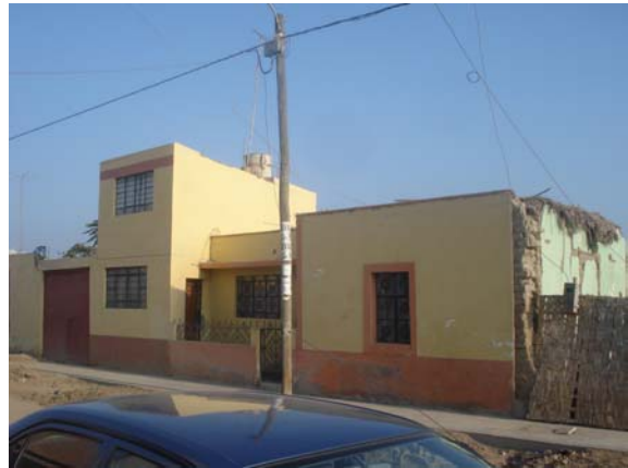
Foto 1.19. Vivienda con daño moderado
