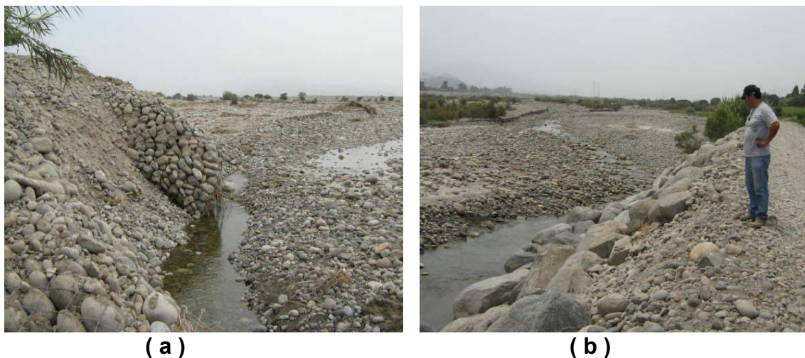
Foto 3.5. Defensas ribereñas que han fallado por socavación lateral. a) Con gaviones en el río Matagente y b) Con defensas de enrocado en el Río Chico.
