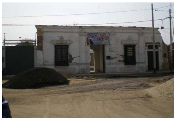
Foto 1.17. Edificio con desplomes parciales
