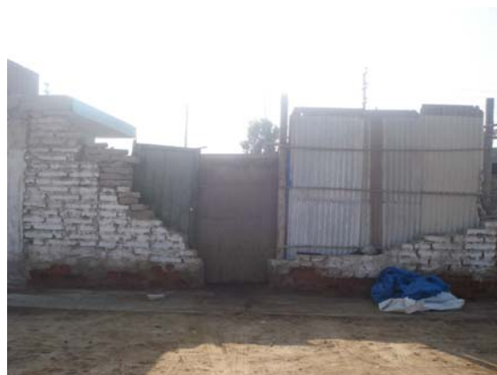
Foto 1.8. Parapeto sin refuerzo
