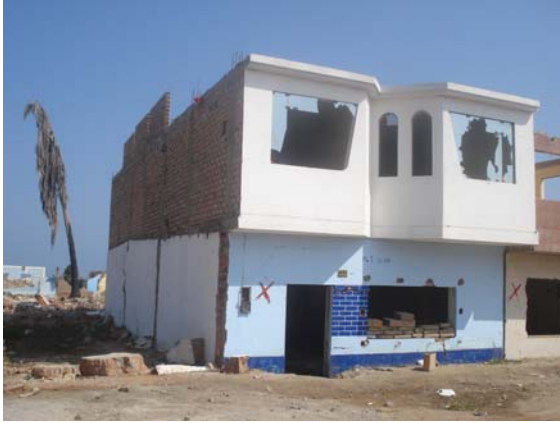
Foto 1.9. Hundimiento de vivienda
