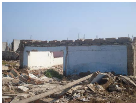
Foto 1.2: Colapso de casa de adobe
