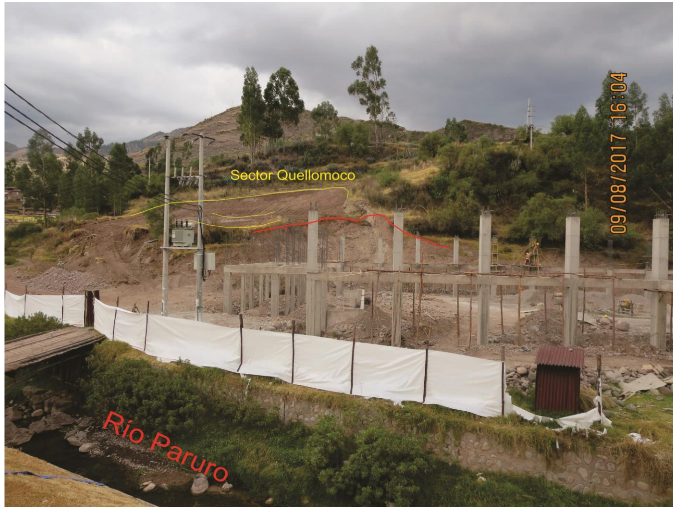
Fotografía 4. Vista tomada con dirección noreste, se observa reactivación de evento (R-2), la presencia de agrietamiento de forma irregular continua con una longitud de 42 m (línea de color amarillo) y un salto vertical hasta de 3 m, también se puede observar al pie de la ladera se realizaron labores de corte de talud (línea de color rojo)
