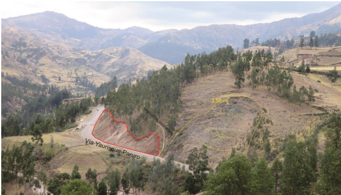
Fotografía 8. Vista del evento (D-4), ubicado en el talud superior de la vía Yaurisque-Paruro, se observa la ocurrencia de un deslizamiento que afecta el tramo de vía asfaltada.
