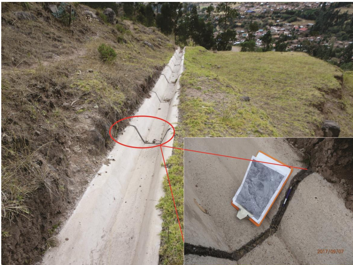
Fotografía 9. Vista de la infraestructura (cuneta de coronación) afectada por la reactivación del deslizamiento (D-1).
