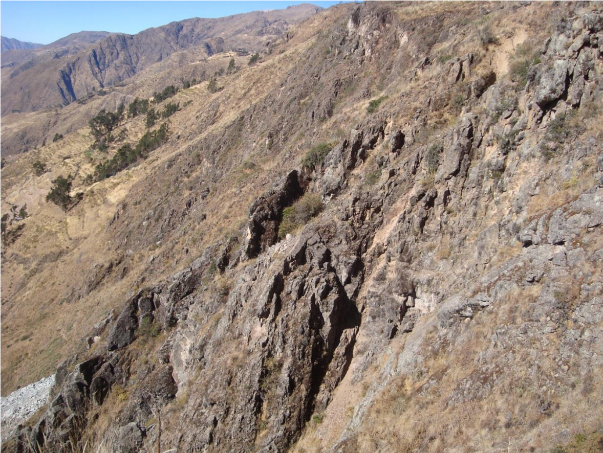
Foto 2. Afloramientos de la Formación Tantará, mostrándose un macizo altamente fracturado.
