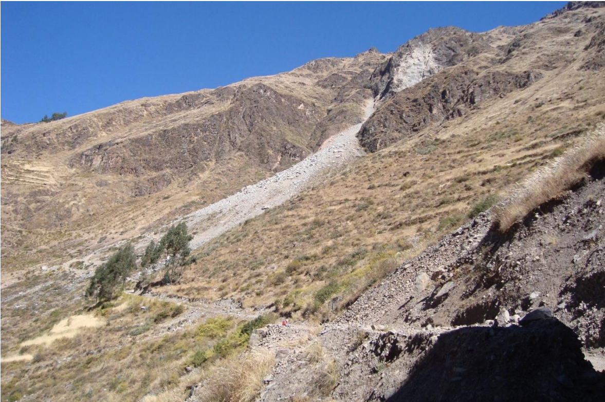
Foto 6. Vista del talud de roca sobre la superficie de la ladera del cerro Huamatambo el cual se extiende sobre la carretera hacia Yllapaza.
