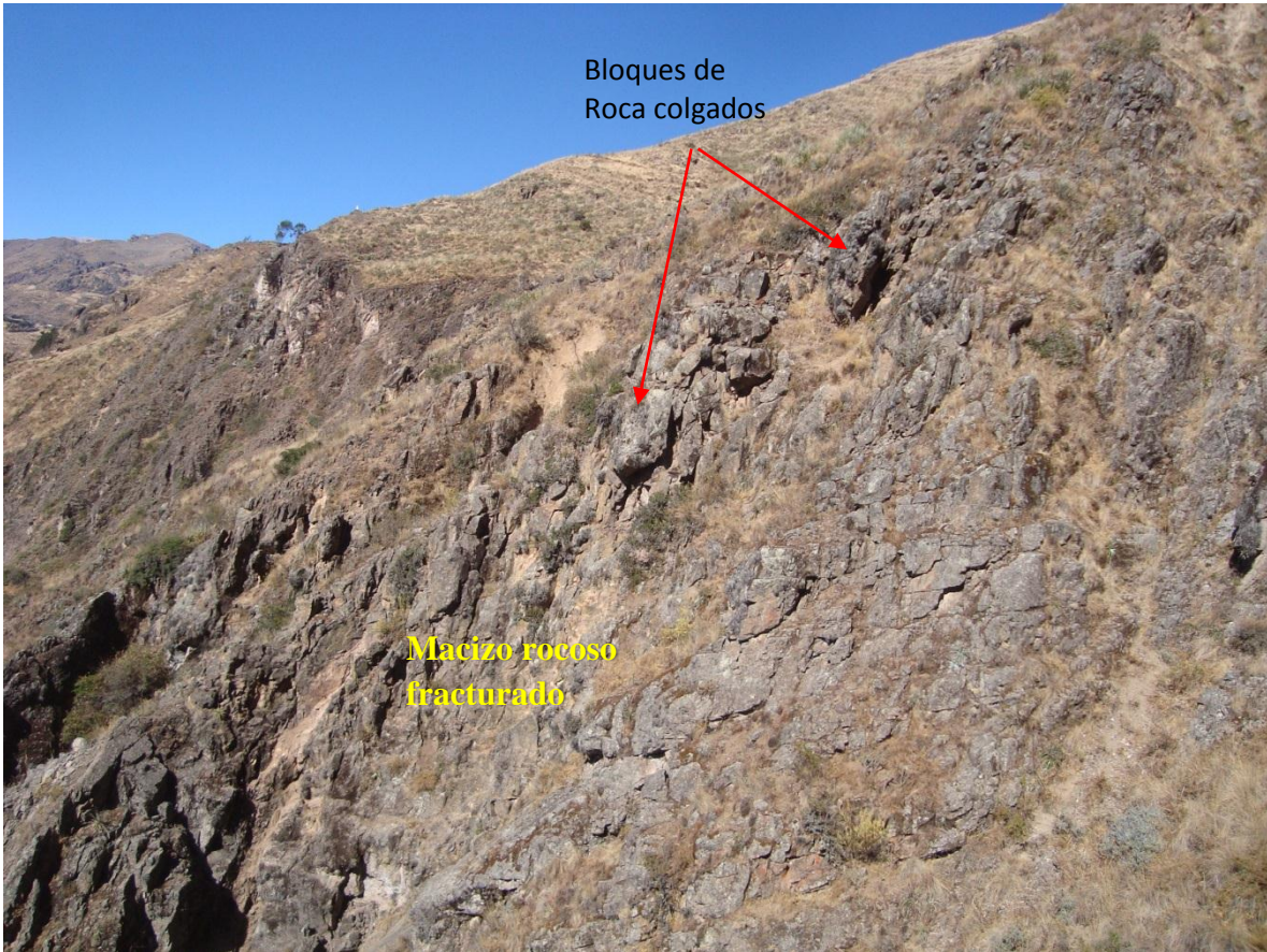
Foto 11. Vista de los bloques de roca colgados en el cerro Huamatambo, Macizo rocoso fracturado, Según GSI (Tabla 1).
