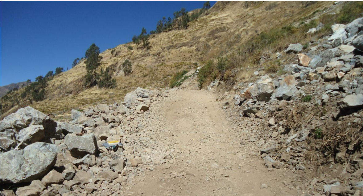
Foto 1. Vista de la carretera Huamatambo – Yllapaza, afectada por la caída de rocas, actualmente operativa
