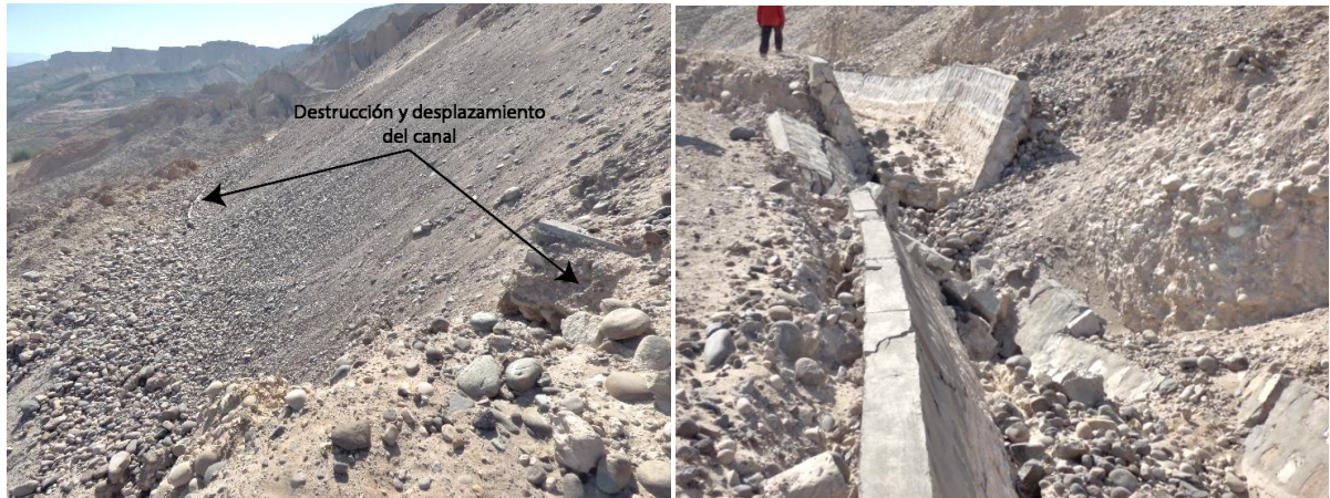
Fotografía 12: Destrucción del canal en el flanco izquierdo del deslizamiento en el sector Gonzales - Telaya.
