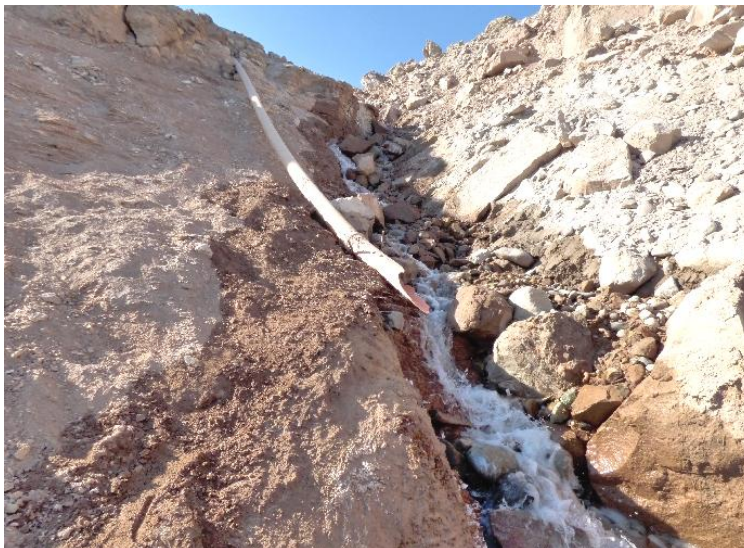
Fotografía 11: Filtraciones en el pie del deslizamiento ocasionan sobresaturación de suelos.
