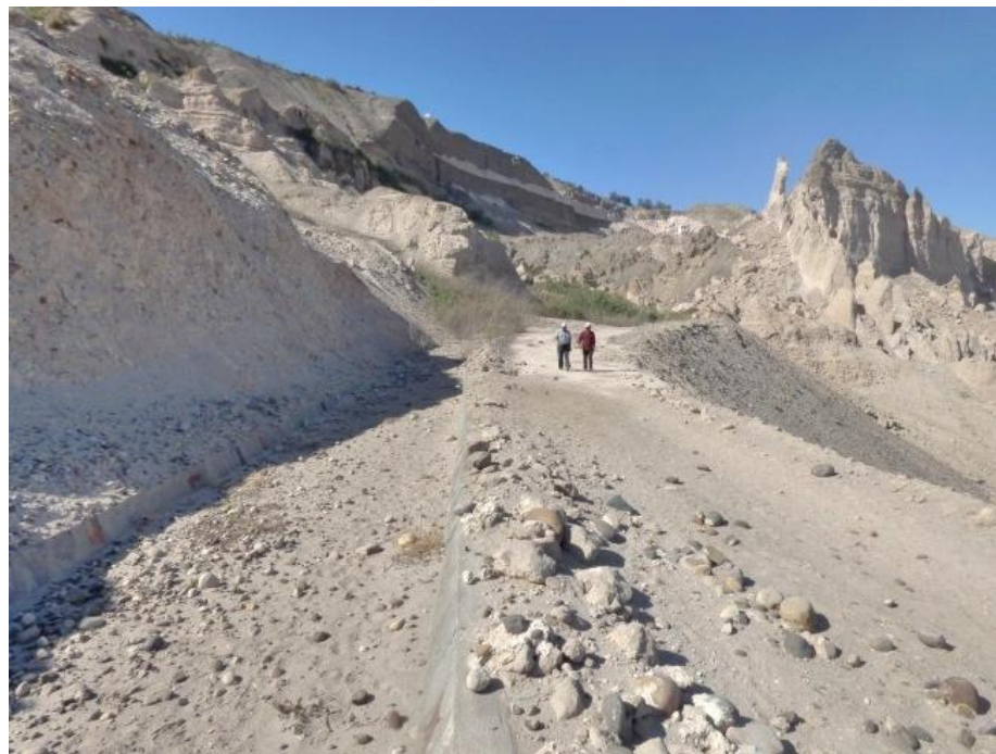
Fotografía 7. Daños en la Infraestructura del canal.
