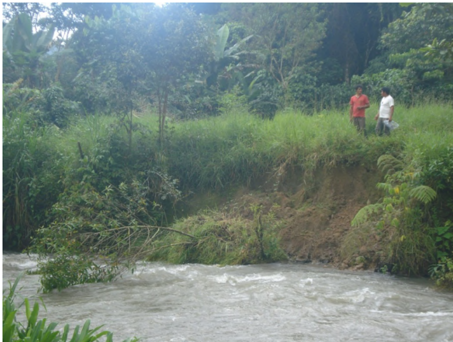
Foto N° 10: Socavamiento en el lecho del río Aguas Claras por los fuertes caudales.
