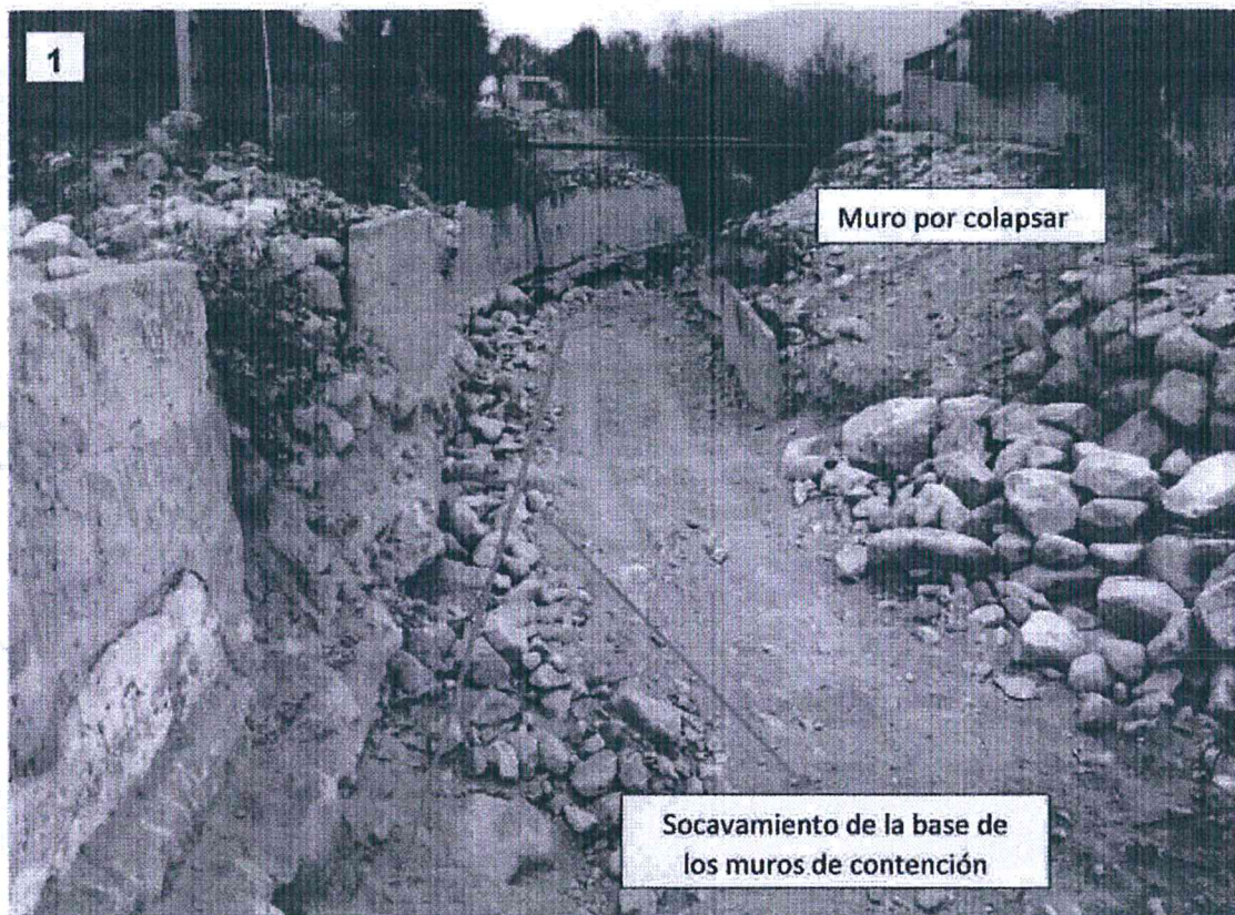
Fotografía 20. Erosión en ambas márgenes de la quebrada Cashahuacra
