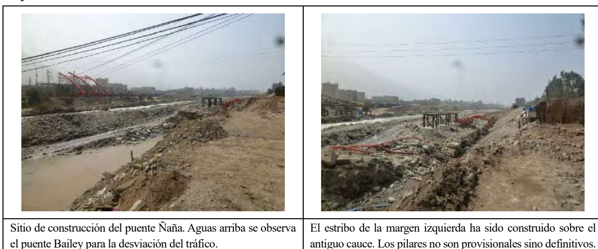
Figura 13.3.102 Condiciones del puente Ñaña
