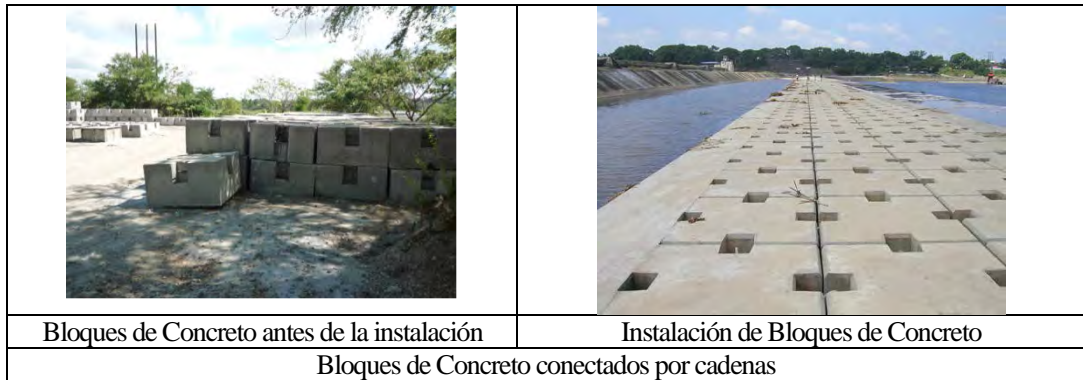
Figura 5.4.6 Ejemplos de Bloques de Concreto instalados en aguas abajo para protección del lecho del Rio
