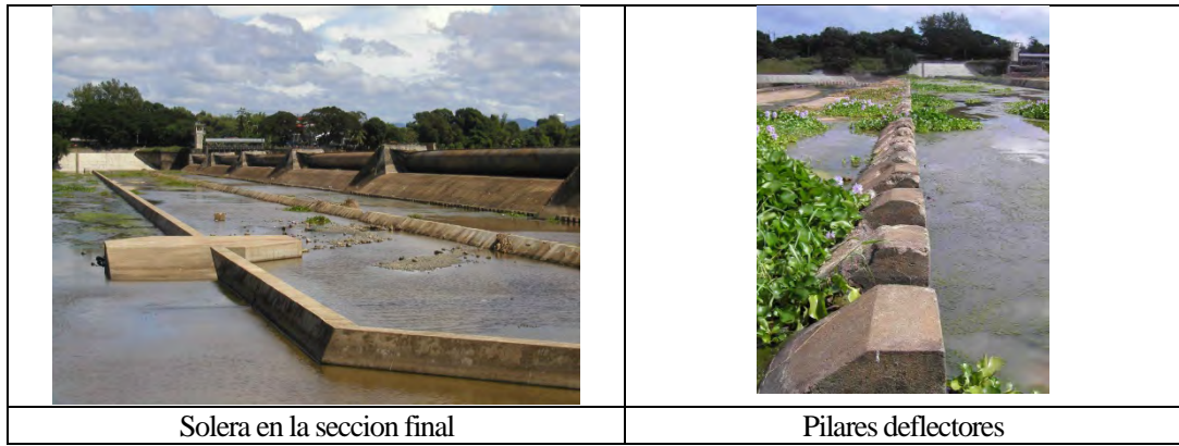
Figura 5.4.5 Diseño de salto Hidráulico forzado por Soleras en la sección final y pilares deflectores
