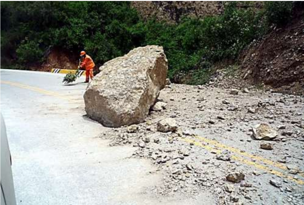
Foto 8: Bloque de roca caído de más de 2 m de longitud, que se incrustó en la plataforma de carretera, se produjo la última semana de enero del 2010.
