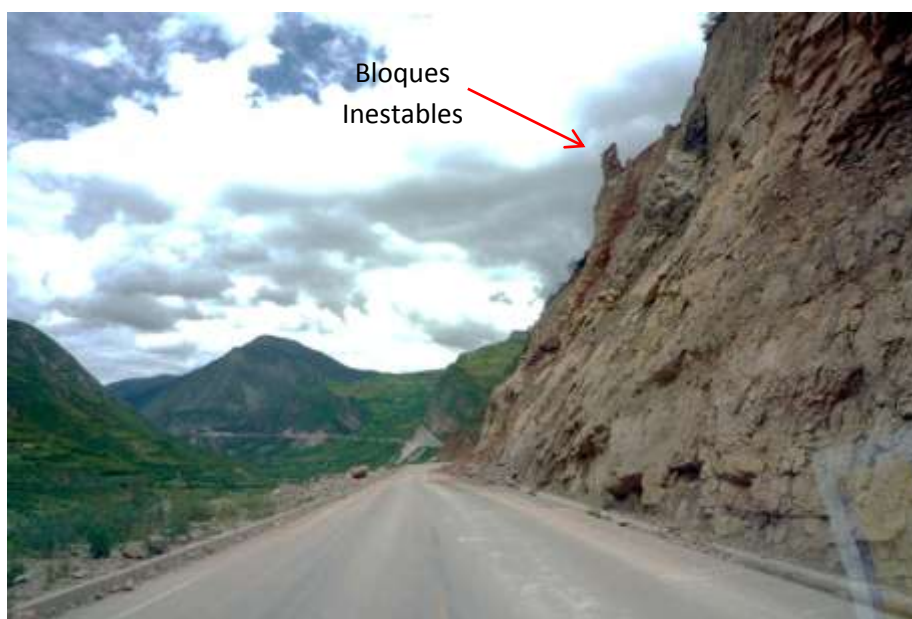
Foto 10: Vista donde se aprecian derrumbes que obstruyen carretera y cuneta, bloques colgados inestables en la parte superior del talud.
