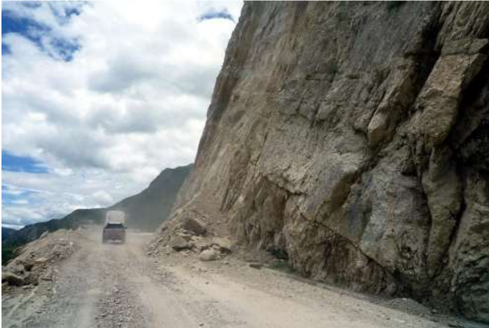
Foto 5, 6 y 7: Vistas de las caídas de rocas y derrumbe producido en el punto Aya-111, la última semana de enero del 2010, este evento bloqueo totalmente el tránsito.
