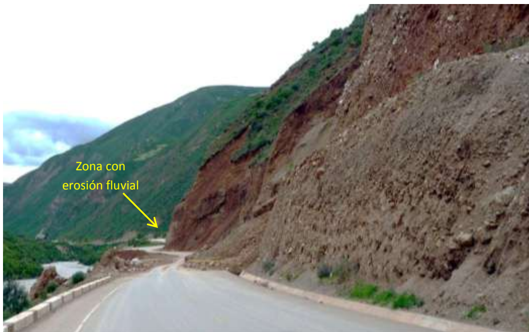
Foto 9: Derrumbes desde el talud superior en el punto Hcy-104, compromete depósitos coluviales y rocas calcáreas alteradas. También se señala con flecha amarilla el talud inferior de carretera afectado por el proceso de erosión fluvial.
